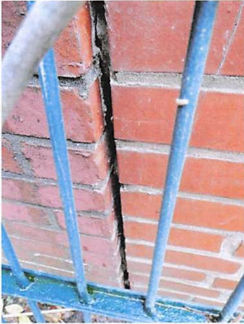
Bild 25: Teilbereich Fassade, Rissbildung
