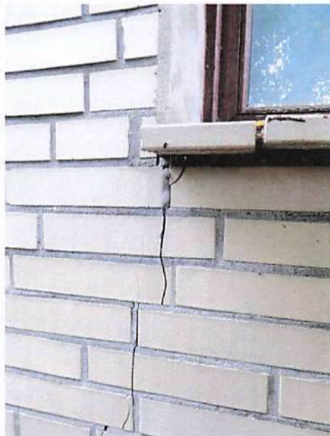
Bild 16: Situation Fassade, Rissbildungen
