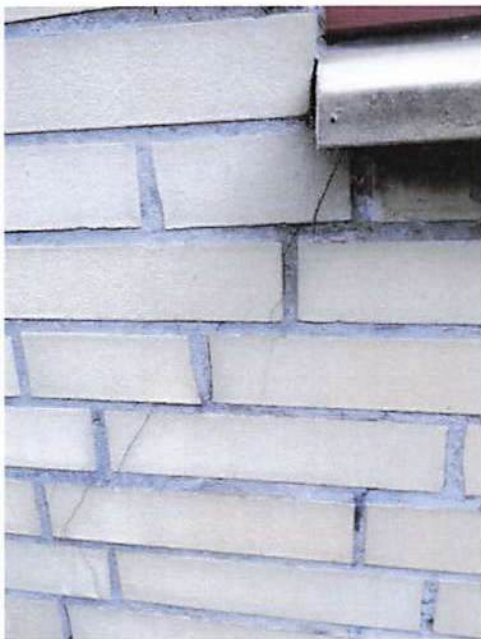
Bild 31: Situation Fassade, Rissbildung
