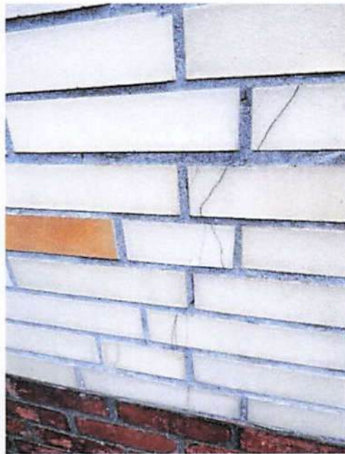
Bild 32: Situation Fassade, Rissbildung
