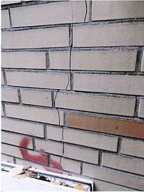
Bild 17: Situation Fassade, Rissbildungen
