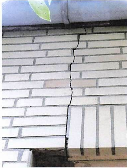
Bild 18: Situation Fassade, Rissbildungen
