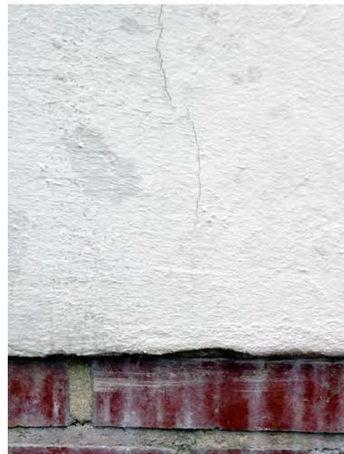
Bild 60: Situation Fassade Rissbildung
