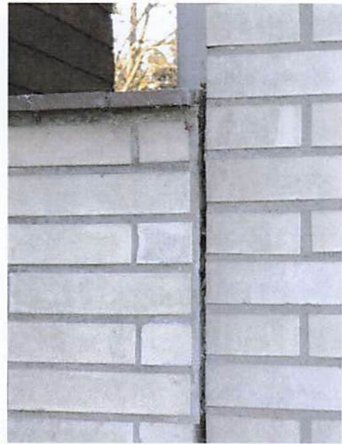
Bild 6: Garage / Wohnhaus / Rissbildung
