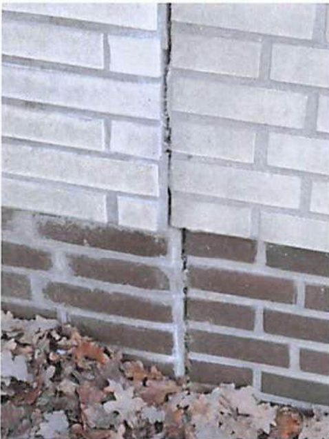
Bild 7: Garage / Wohnhaus / Rissbildung
