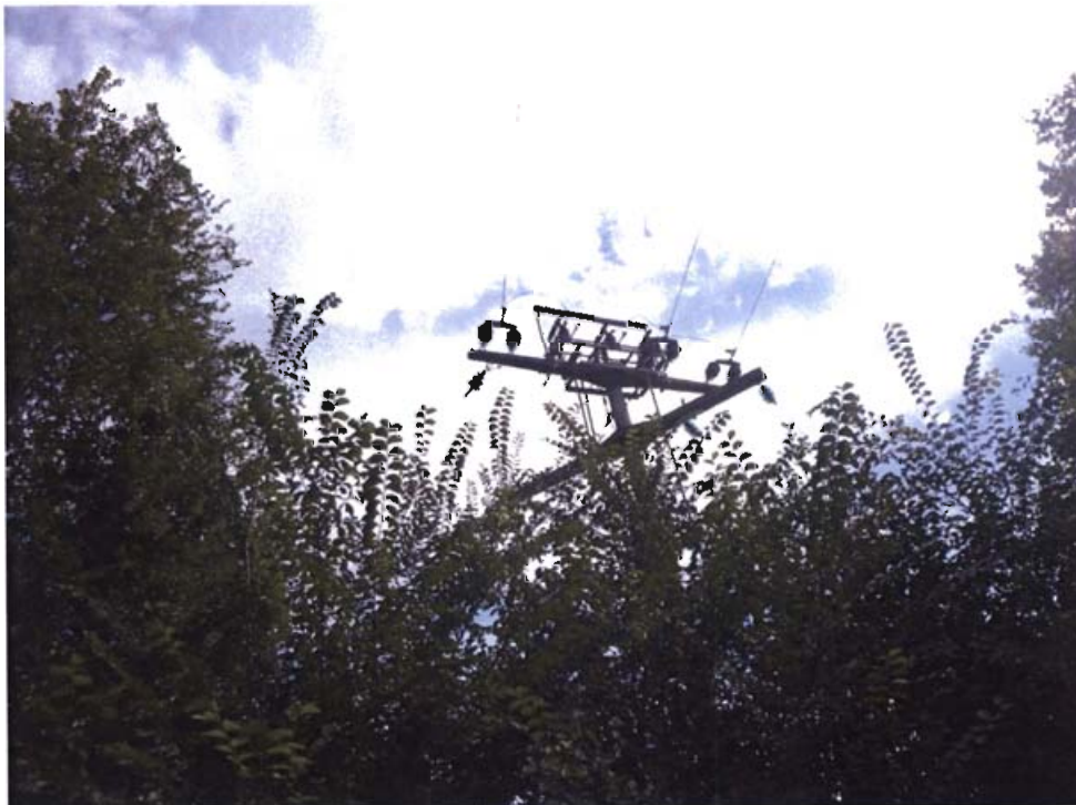
Ansicht der Hochspannungsleitung
