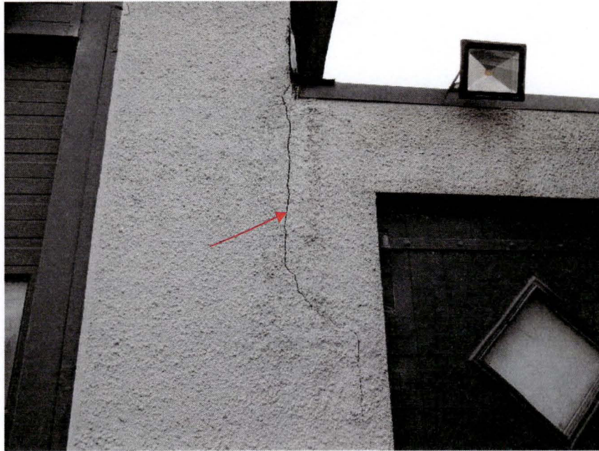
Bild 9: Rissbildung zw. Halle 1 und Garage 1
