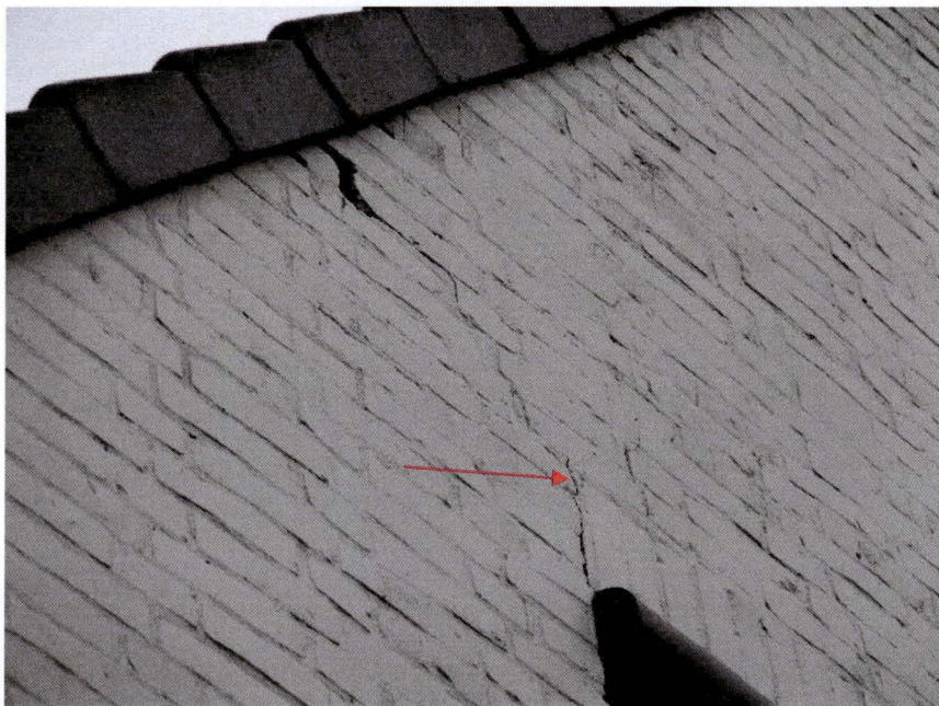
Bild 22: Wohnhaus Beispiel Rissbildung beim Schlafzimmerfenster
