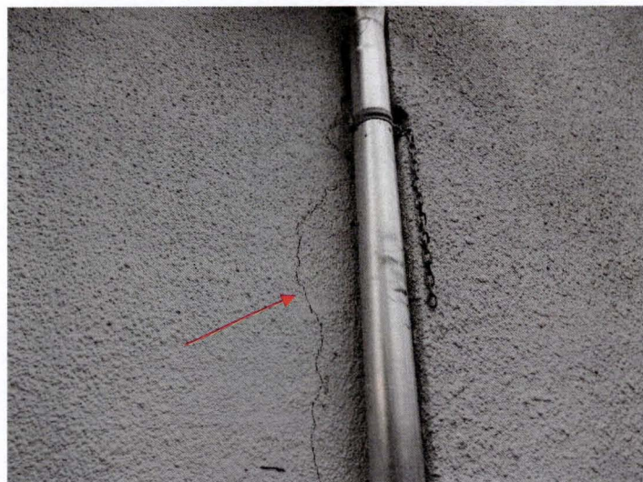
Bild 14: Rissbildung im Übergangsbereich Wohnhaus / Halle 2
