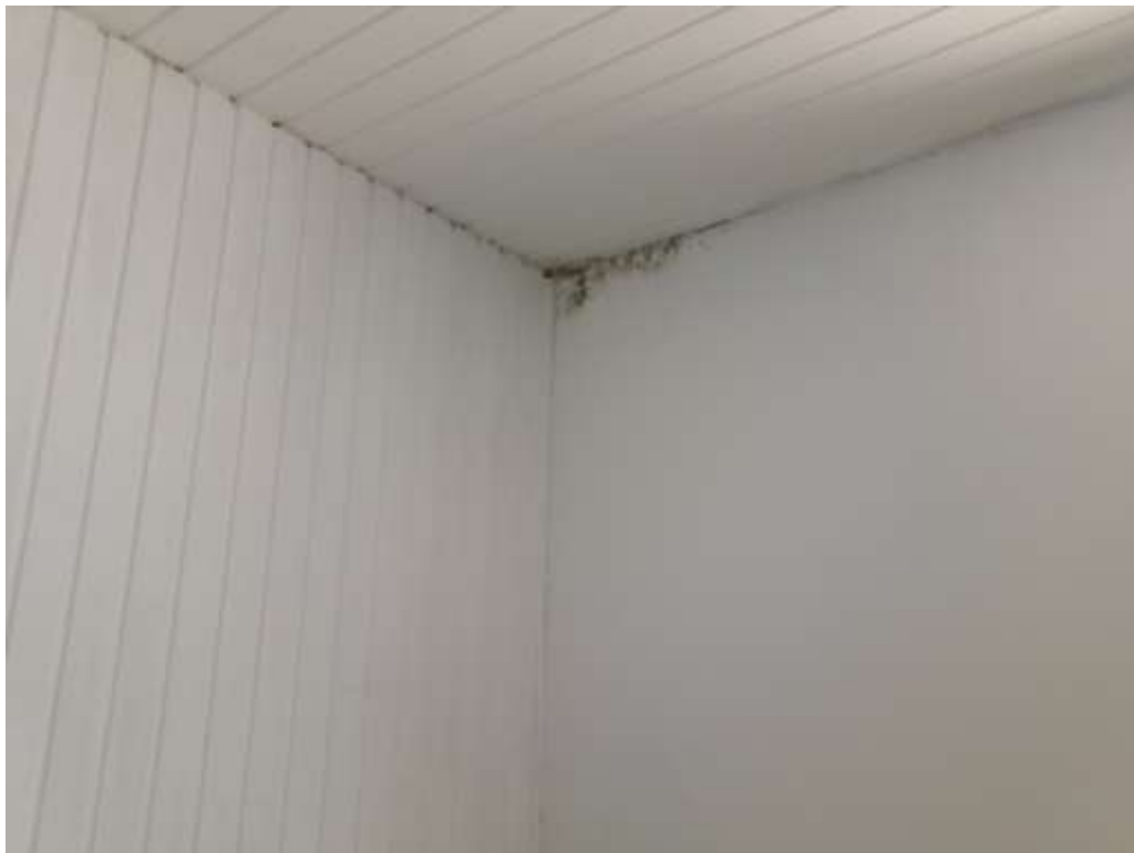
EG: Zimmer – Schimmelflecken im Deckenbereich
