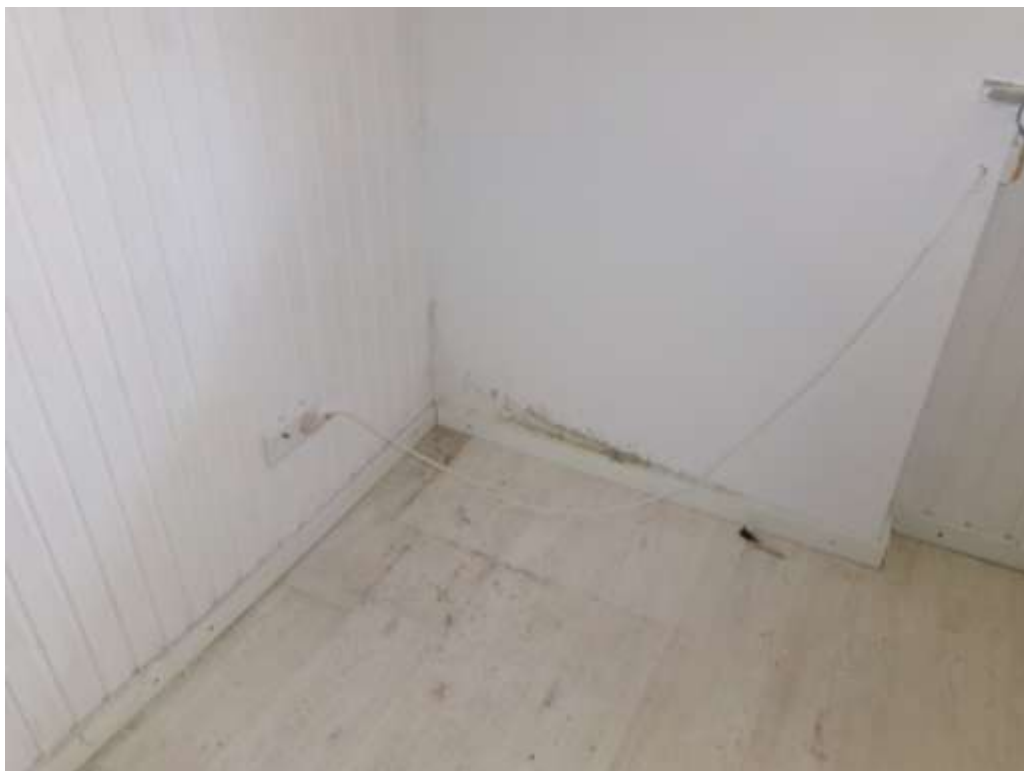
EG: Zimmer – Schimmelflecken im Sockelbereich
