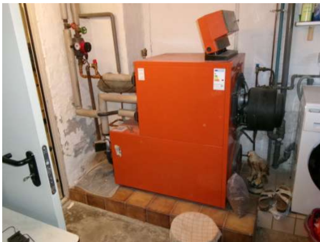
Vorderer Gebäudeteil – KG: Heizungsraum/Waschküche
