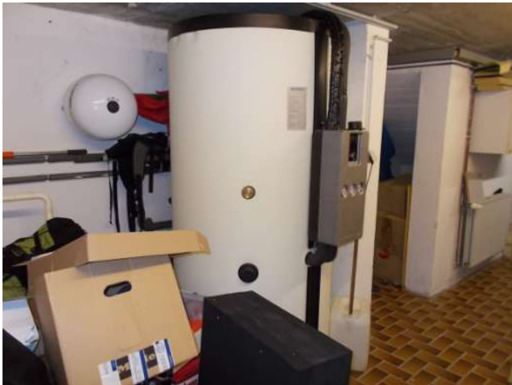
KG: Abstellraum II + III mit Speicher für Solarthermie
