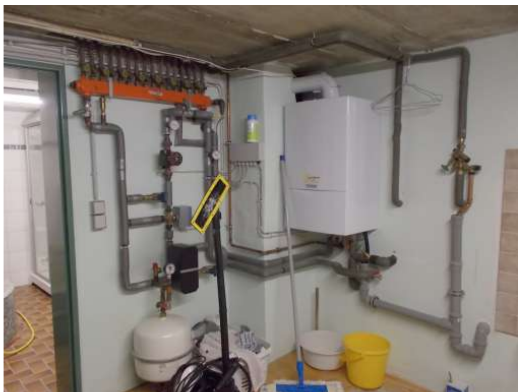
KG: Heizungsraum mit Gastherme
