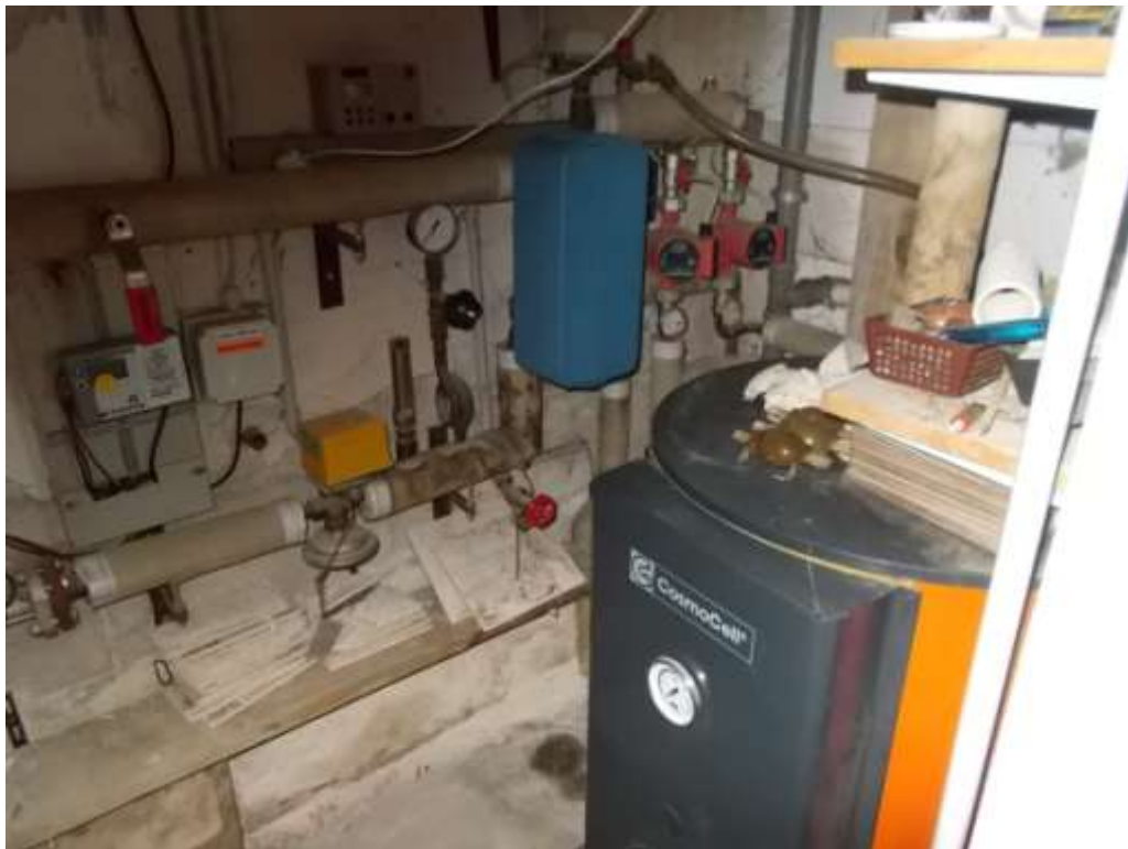
KG: Kellerraum mit Hausanschlüssen und Fernwärmeanschluss
