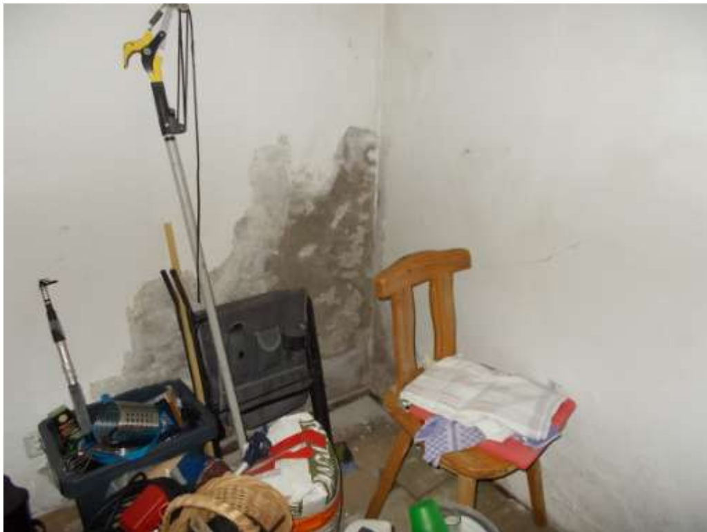
KG: Kellerraum mit Feuchtigkeit im Wandbereich
