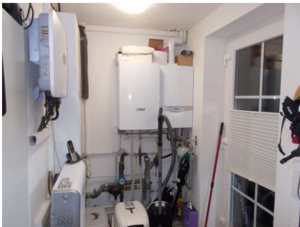
Whg. 1 EG: HRW mit Gastherme und Batteriespeicher
