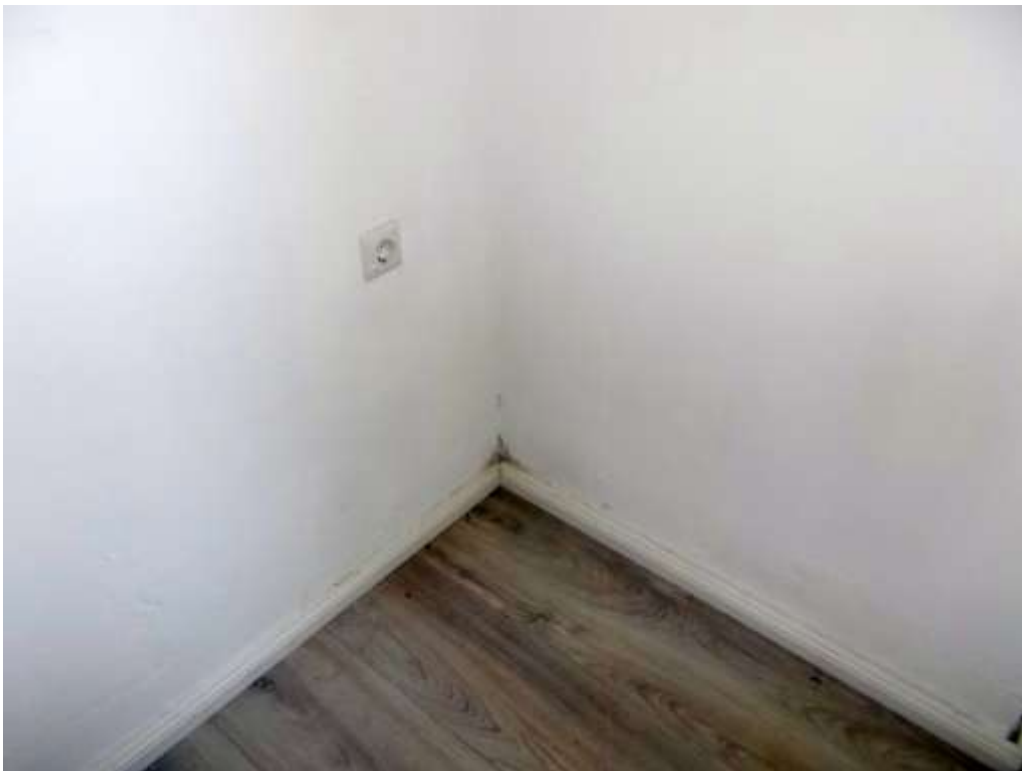
Whg. 5: Zimmer – Stockflecken an der Außenwanddecke
