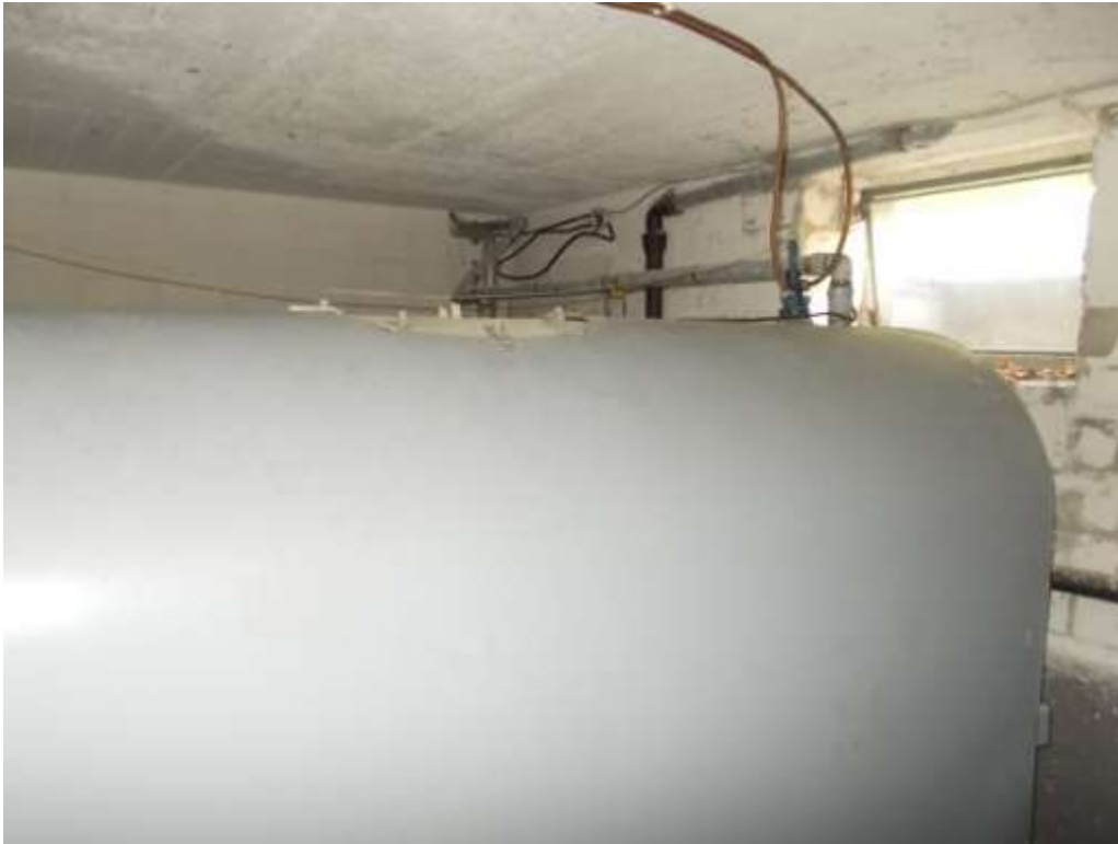
KG: Öllageraum mit Stahlöltanks
