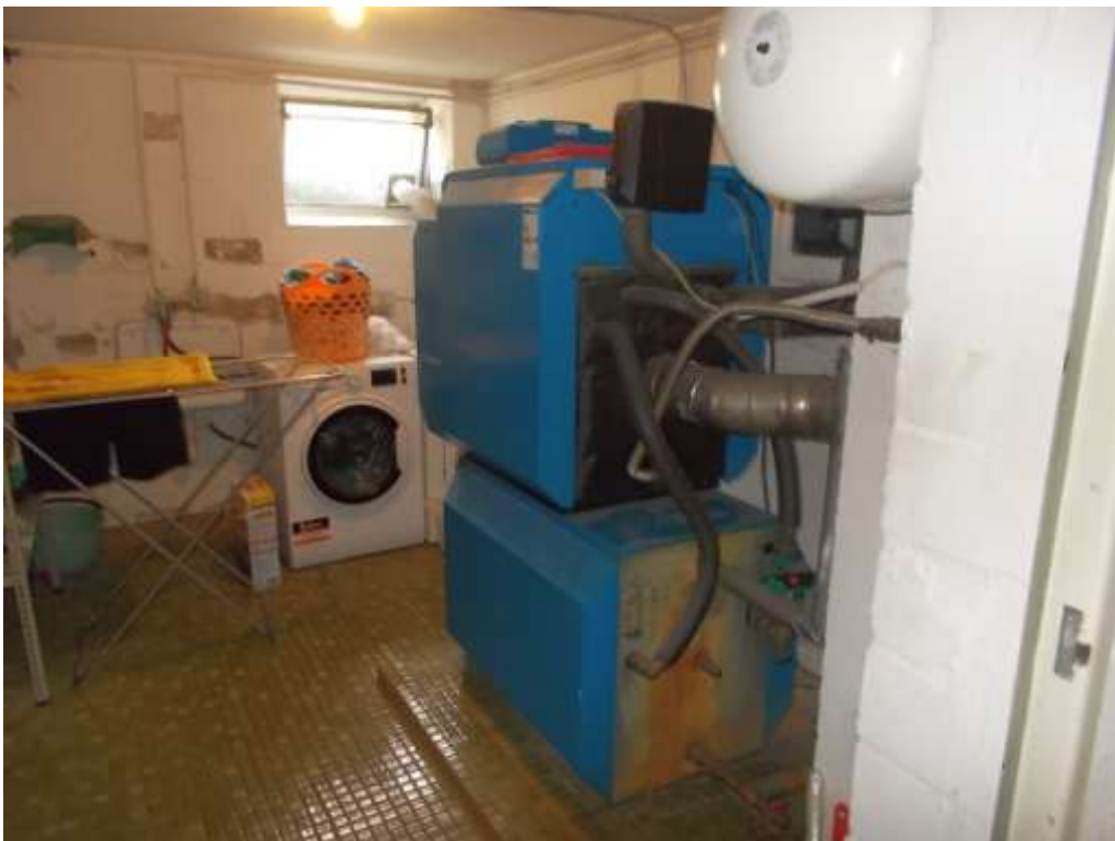
KG: Heizungsraum mit Ölfeuerungsanlage
