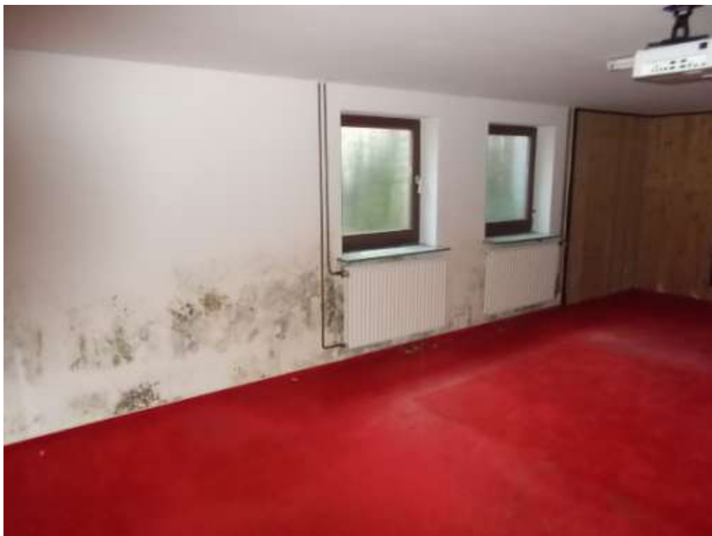
KG: Kellerraum mit Schimmelbildung
