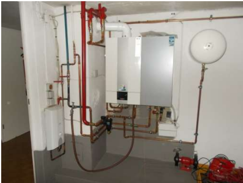
KG: Heizungsraum mit Gasterme
