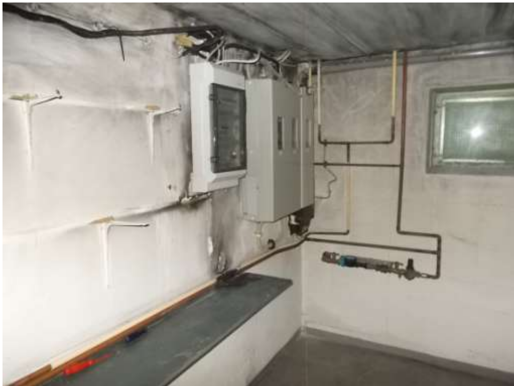
KG: Kellerraum mit altem Brandschaden
