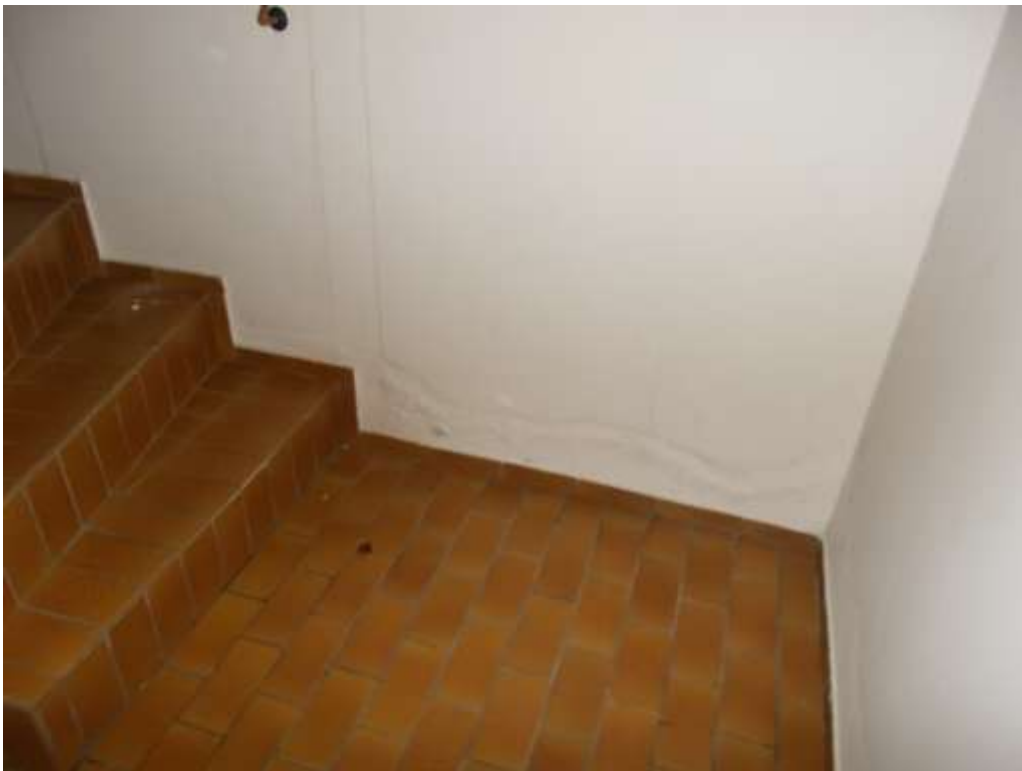
KG: Treppenhaus – aufsteigende Feuchtigkeit im Wandbereich
