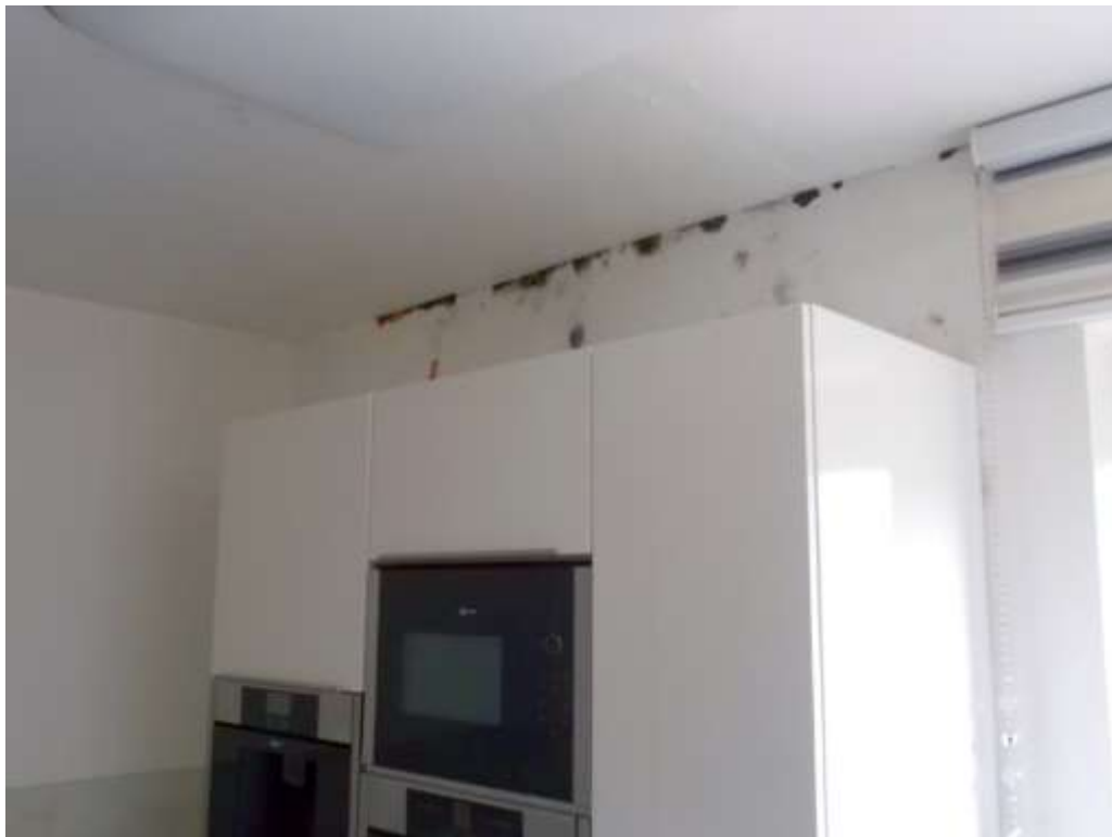
EG: Küche mit Schimmelbildung an der Außenwand
