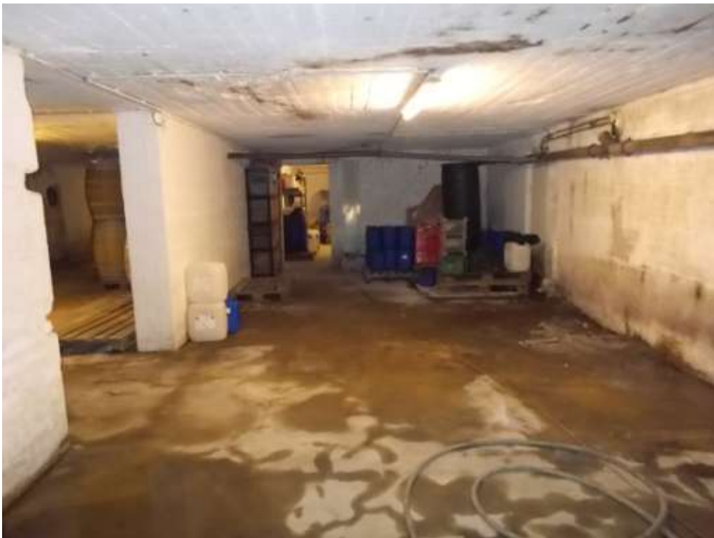
KG: Kellerraum mit Feuchtigkeitseintrag
