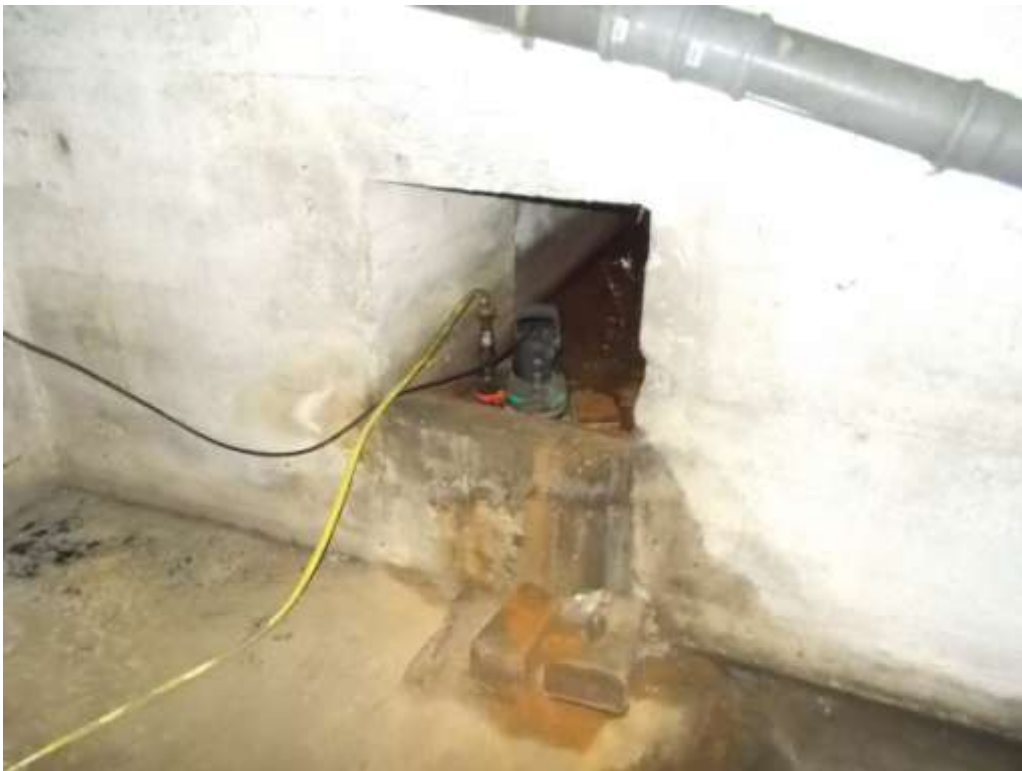
KG: Kellerraum – Tauchpumpe
