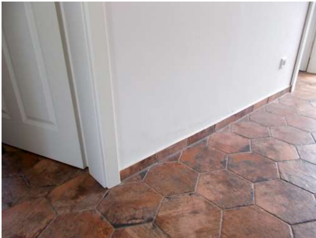
EG: Diele mit aufsteigender Feuchtigkeit an der Wand zur Küche/HWR
