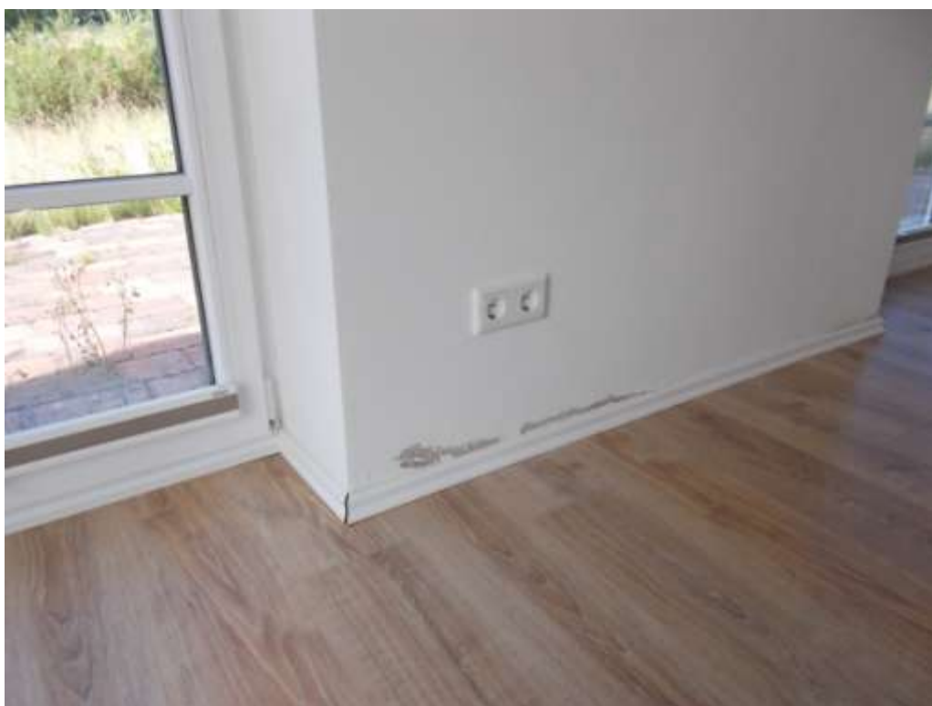
EG: Wohn- und Esszimmer – aufsteigende Feuchtigkeit an der Außenwand
