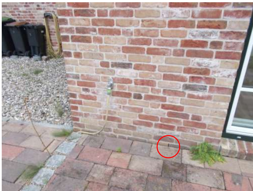
Terrasse: Offene Stoßfugen der Verblendung unterhalb der Pflasterung
