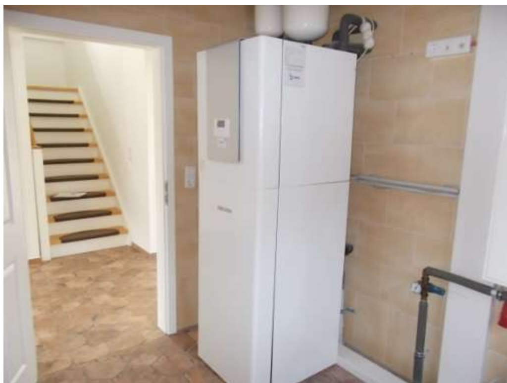
EG: HWR mit Wärmepumpe
