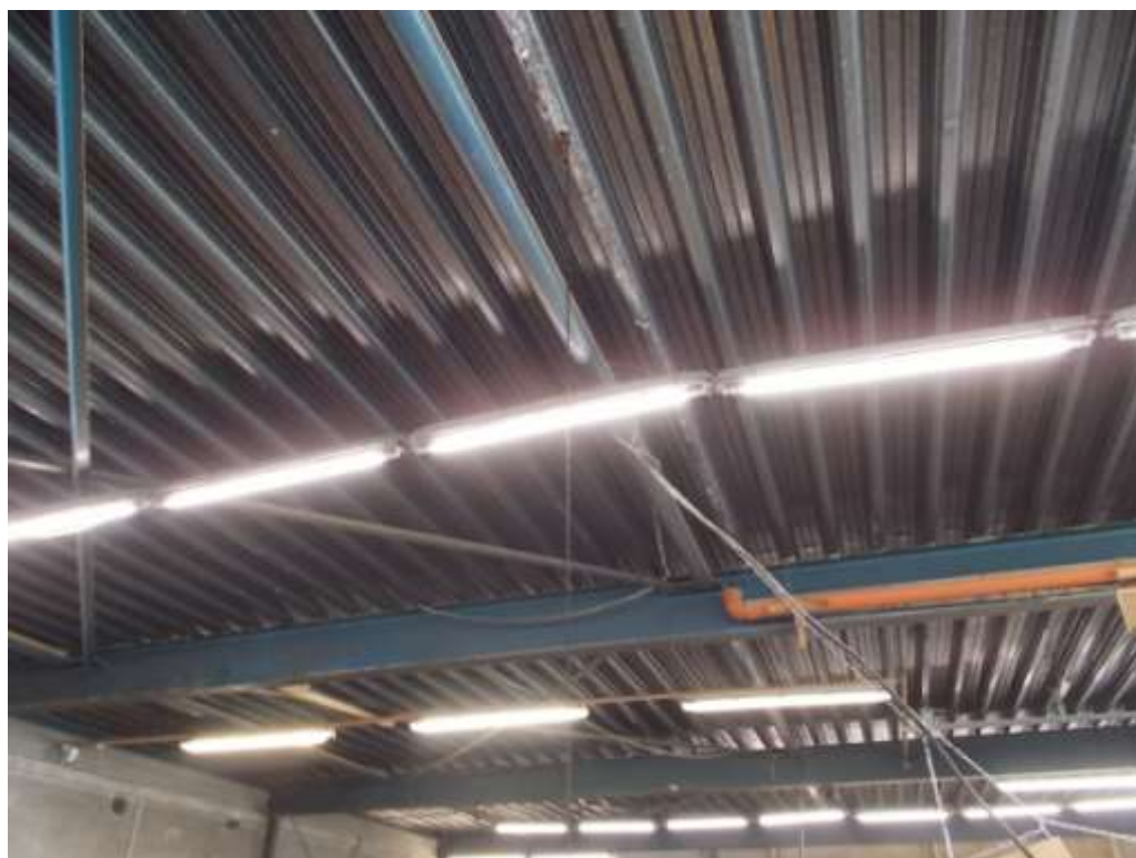
Werkstatthalle – Schäden an der Dacheindeckung
