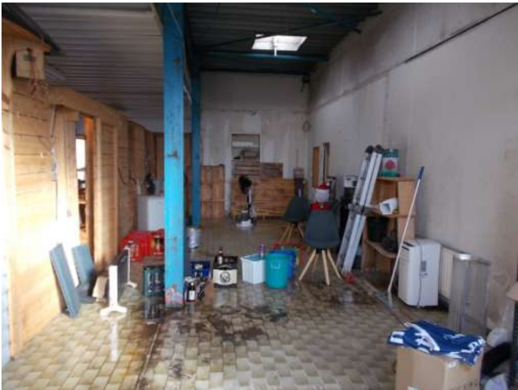
Ausstellungshalle: Bereich ehem. Büroräume – Wassereintrag durch das Dach
