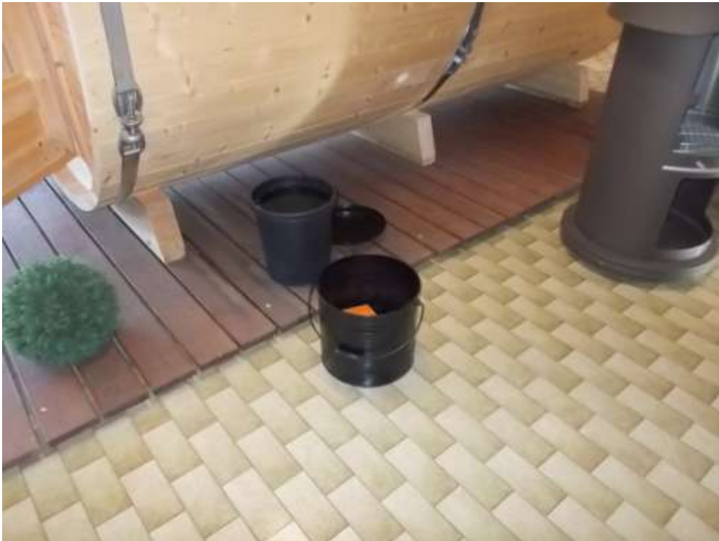
Ausstellungshalle: Undichte Dacheindeckung
