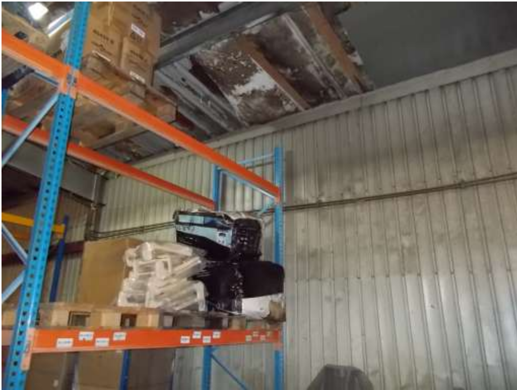
Innenansicht Hallengebäude - Schäden an der Dacheindeckung
