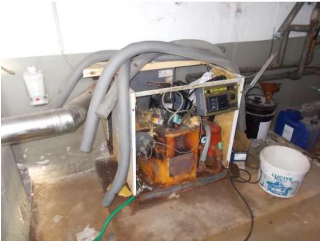
Rückwärtiger Heizungsraum mit Heizungsanlage
