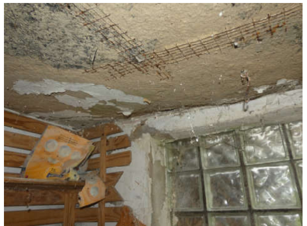
Feuchtigkeitsschaden Decke / Garage
