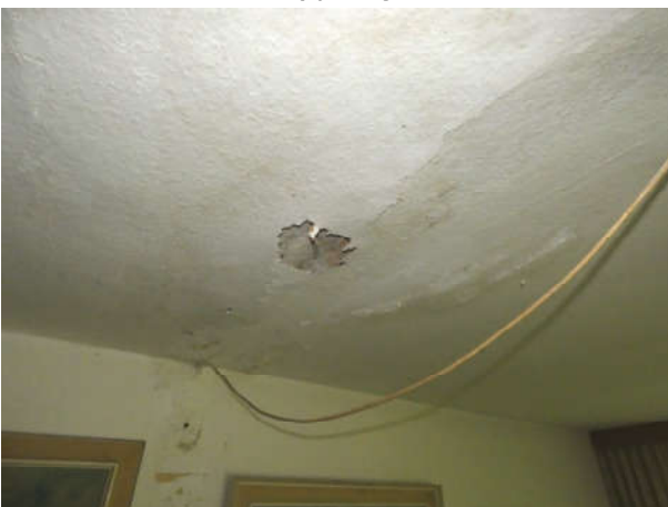
Feuchtigkeitsschaden Decke / Wand Wohnzimmer
