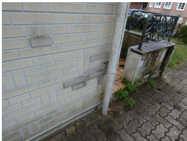
Schäden an der Kunststofffassade
