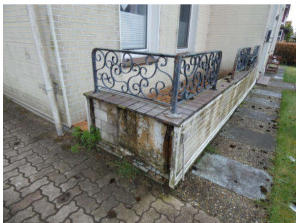
fehlende Verkleidung an der Terrasseneinfassung
