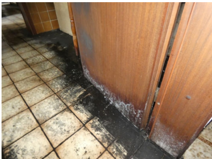
Schimmel an den Türblättern / Zargen
