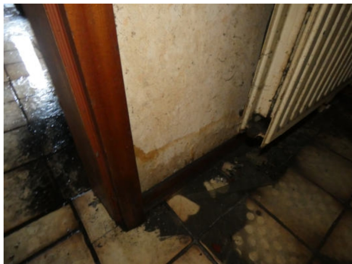
aufsteigende Feuchtigkeit im Mauerwerk
