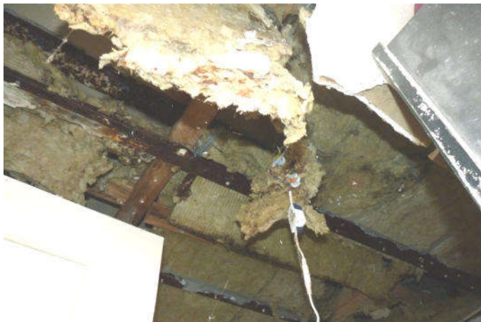
durchfeuchtete Decke im Bad II EG
