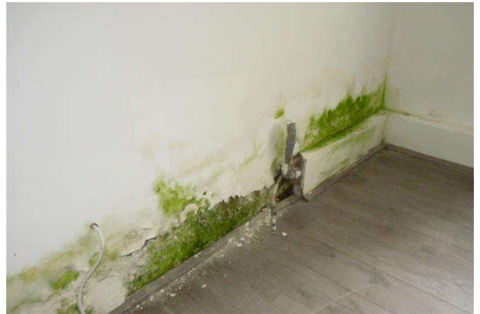
aufsteigende Feuchtigkeit im Mauerwerk
