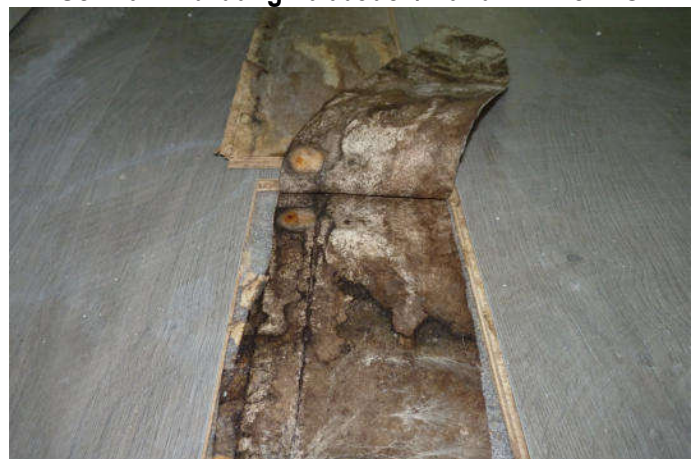
durchfeuchteter Fußboden EG
