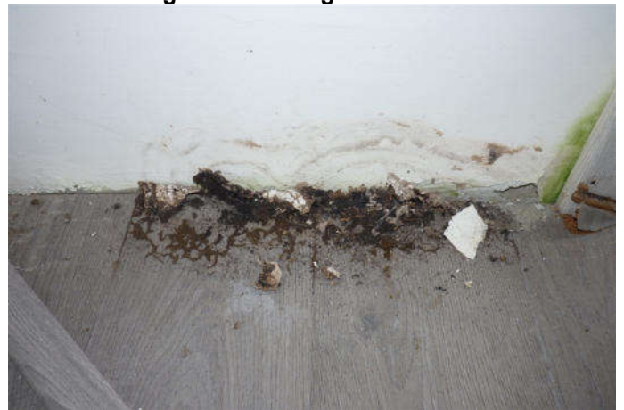
Schwammbildung Fußboden/Wand Zimmer EG
