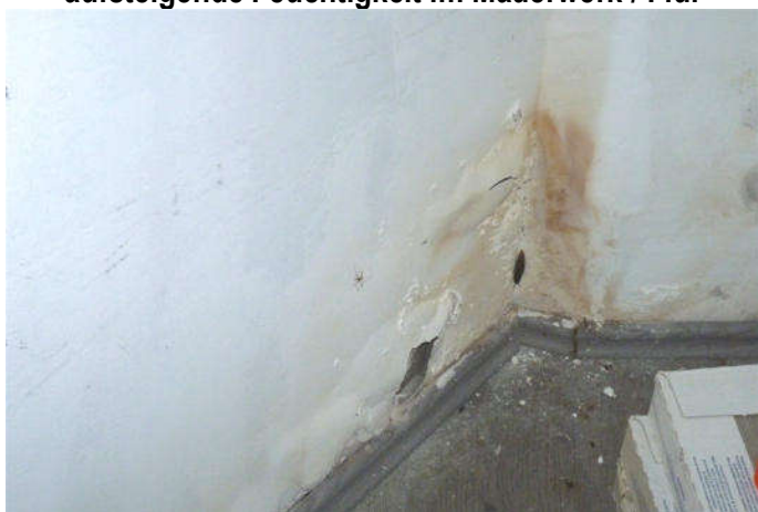
aufsteigende Feuchtigkeit im Mauerwerk / Flur
