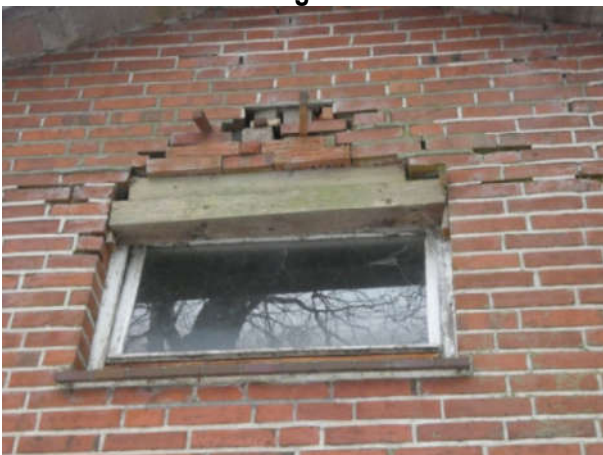
Schäden am Fenstersturz / Verblendmauerwerk
