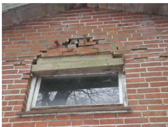
defekter Sturz / Fugenschäden
