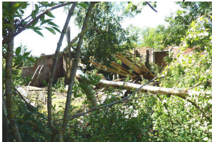
Bauschutt auf dem Grundstück
