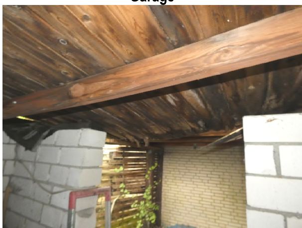
Abstellraum / Feuchtigkeitsschaden Dach
