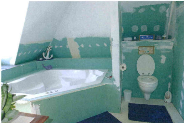
21. Bad nicht fertiggestellt
