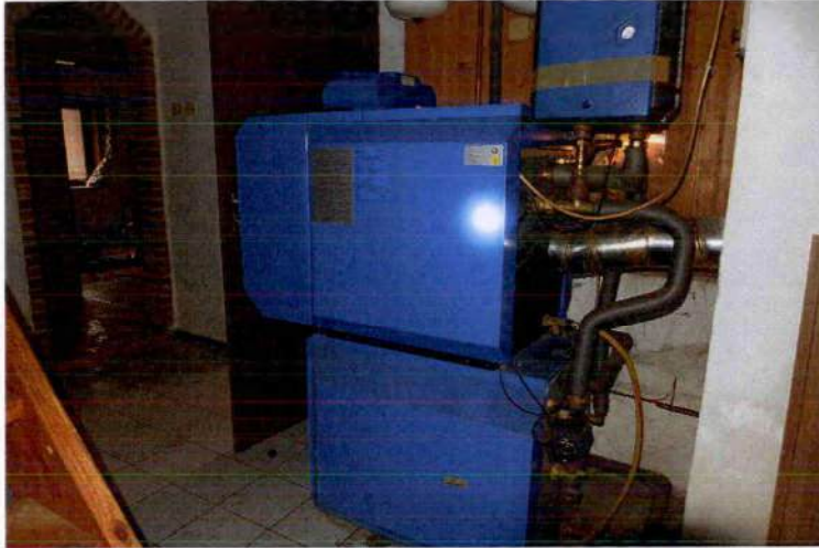
28. Diele mit Heizung
