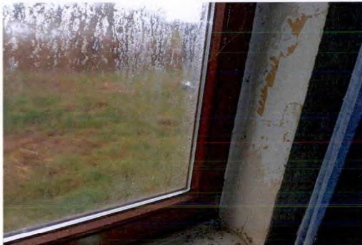
35. Marode Fenster /Feuchtigkeit
