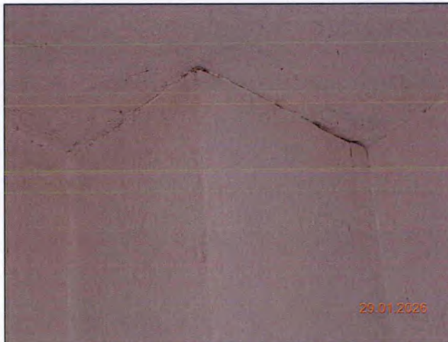
Schimmelbildung an Rohrverkleidung
