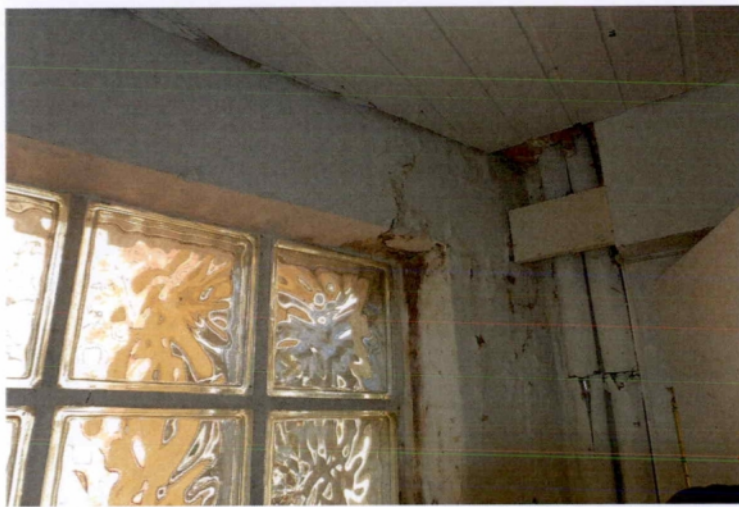
14. Raumecke Waschküche /Schimmel
