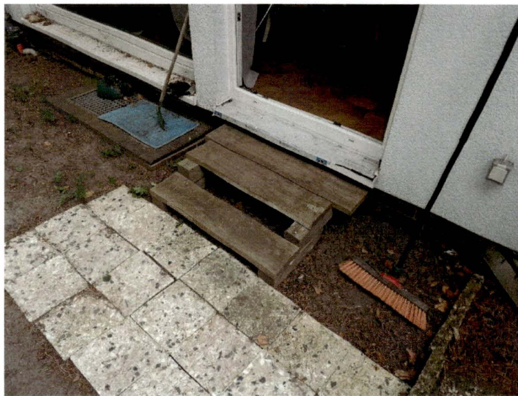
Bild 11: Terrassentür / fehlende Trittstufe
