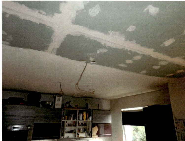
Bild 16: Decke in der Küche nicht verputzt
