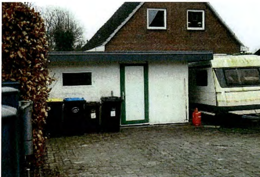
Bild 6: Schuppen im Vorgartenbereich mit Müllbehältern ohne Einstellvorrichtung
