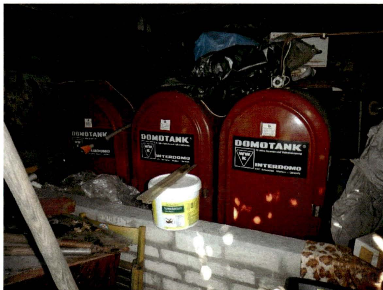
Bild 24: Tanks der Ölheizung
