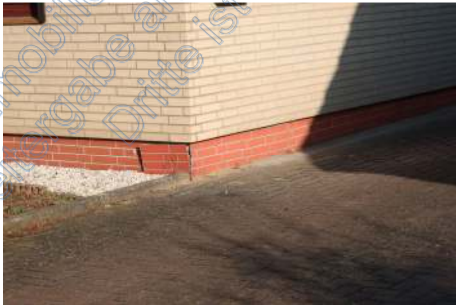
Detailansicht lose Sockelverkleidung
