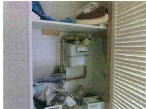
Zählerschrank Flur EG
