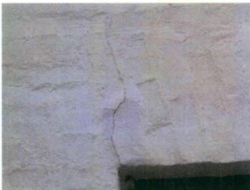
Risse in der Fassade
