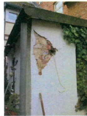
Putzabplatzungen am Schuppen
