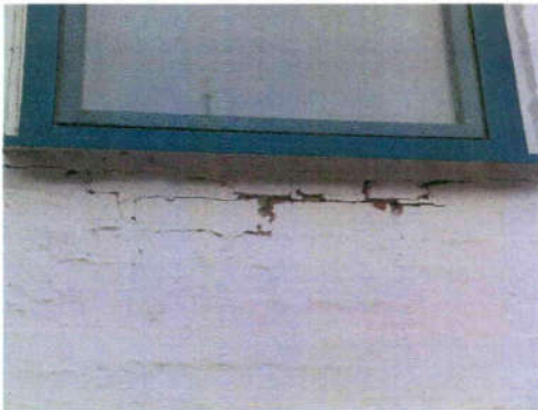
Risse in Fugen unter Fenster OG
