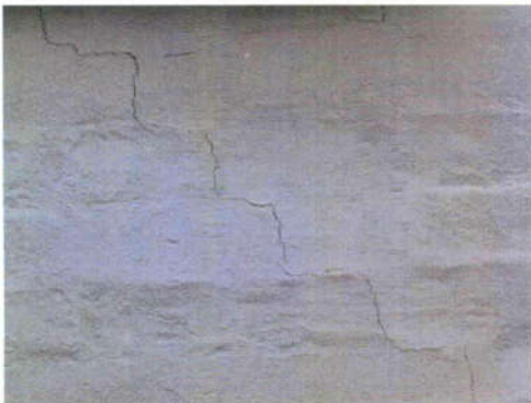
Risse in der Fassade
