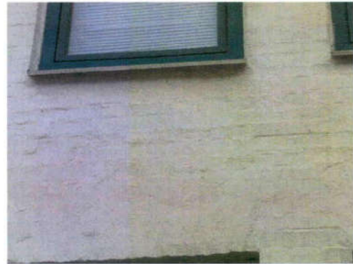
Risse in der Fassade
