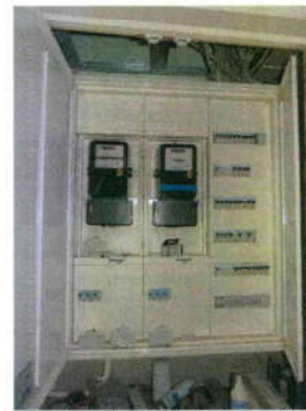
Zählerschrank / E-Verteilung Flur EG
