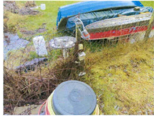
Stromanschluss am Boots- /Badesteg
