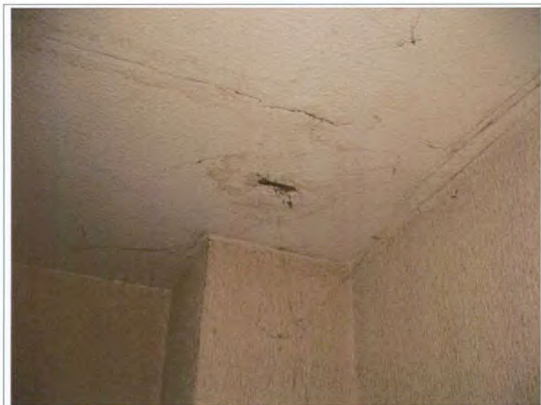
Foto 55: Feuchte Stelle am Abluftzug
