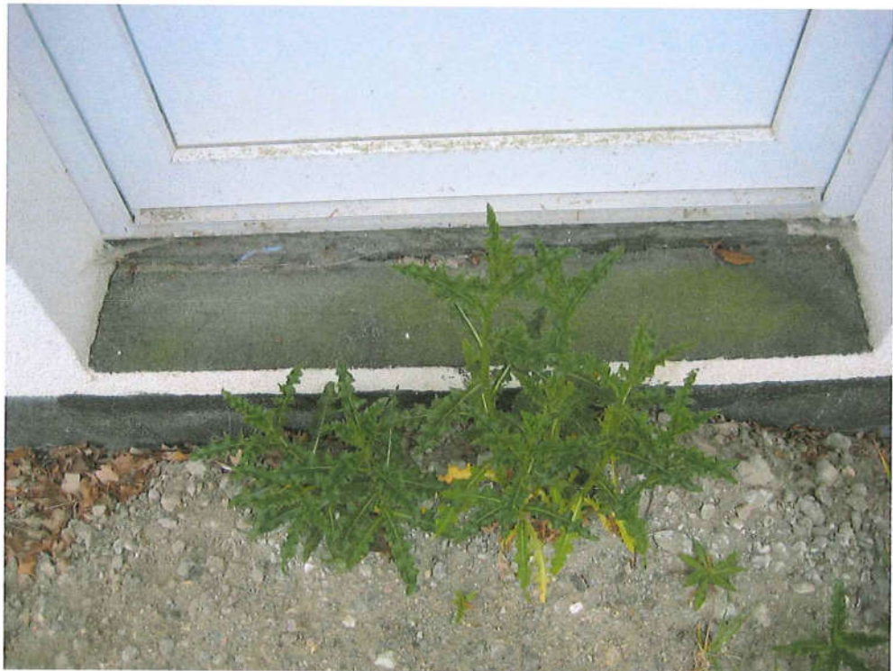
10: defekte Fassadendämmung in der Türschwelle
