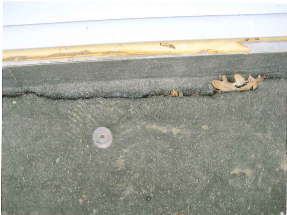
08: defekte Fassadendämmung und gerissener Dichtanstrich
