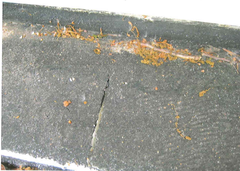
13: defekte Fassadendämmung im Bereich der Schwelle der Fenstertür
