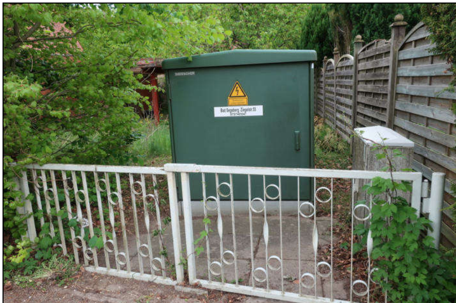
Detailansicht Transformatorstation und Stromkasten
