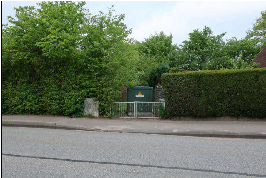
Straßenansicht Ziegelstraße mit Zugang Flurstück 1/21 (Transformatorstation)
