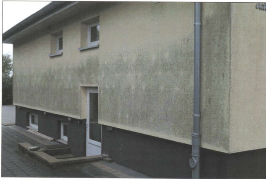
Seitenansicht mit Verfärbungen Fassade
