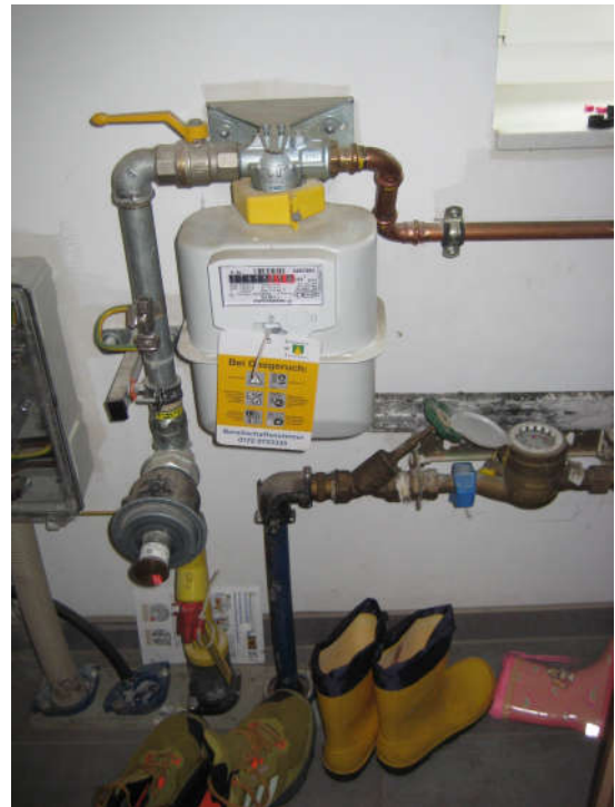
49: Gas- und Wasseranschluss im HWR
