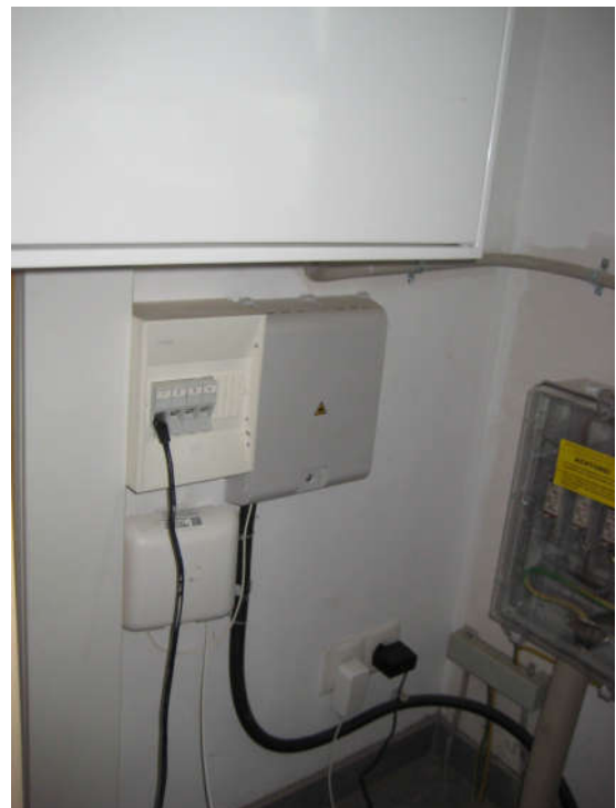
50: Stromanschluss im HWR
