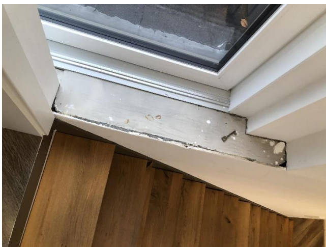
Bild 19 von 22 Blick auf einen nicht verputzten Sockelbereich unterhalb der Terrassentüre und auf die Bitumenbahnen der Terrasse
