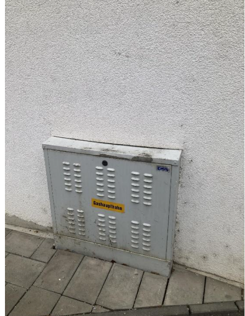
Bild 22 von 22 Blick auf den Gashaupthahn
