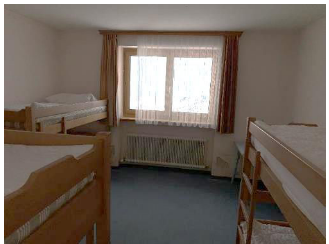
Bild 76 von 88 Blick in das Zimmer 102 (samt Feuchtigkeitsschäden im Sockelbereich)
