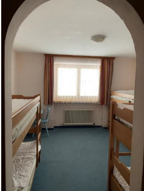
Bild 77 von 88 Blick in das Zimmer 103 (samst Feuchtigkeitsschäden im Sockelbereich)
