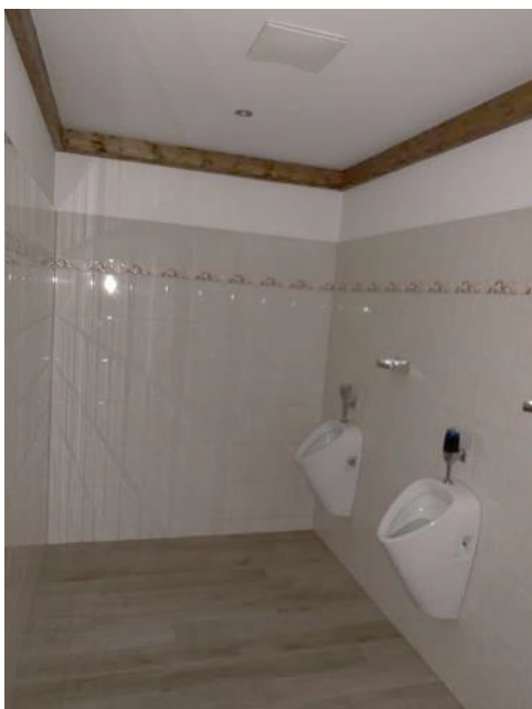
Bild 59 von 88 Blick in das Herren-WC
