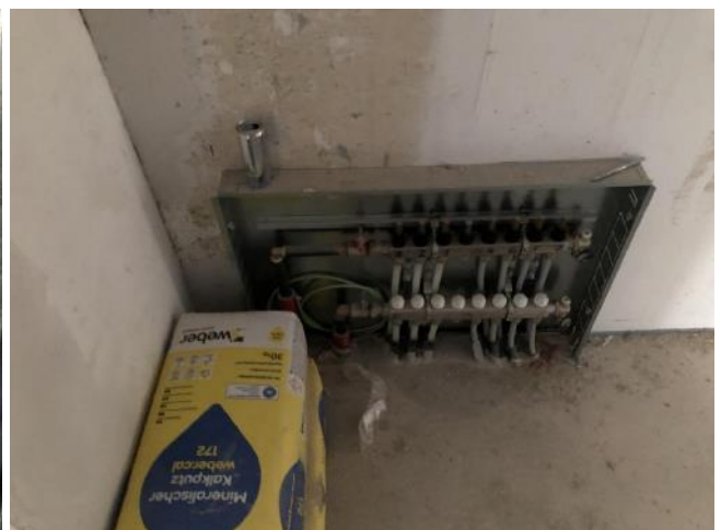
Bild 16 von 38 Blick auf einen Fußbodenheizungsverteiler
