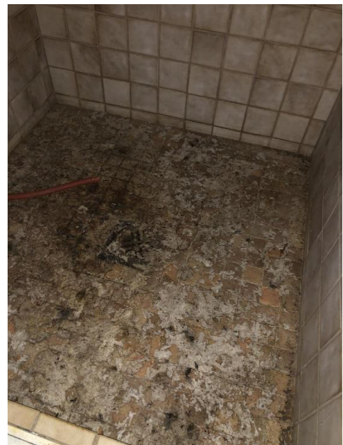
Bild 12 von 38 Blick auf den schadenhaften Bodenbelag in einer Dusche
