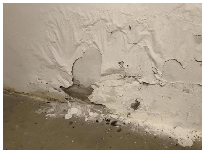
Bild 8 von 38 Blick auf Feuchtigkeitsschäden im Wasraum
