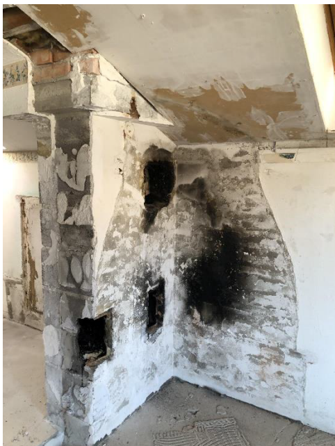
Bild 27 von 38 Blick auf den Kaminanschluss
