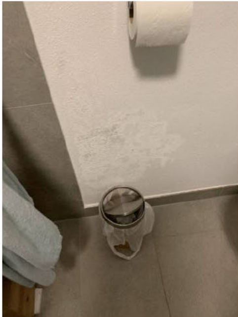
Bild 9 von 60 Blick auf die Feuchtigkeitsschäden im Badezimmer
