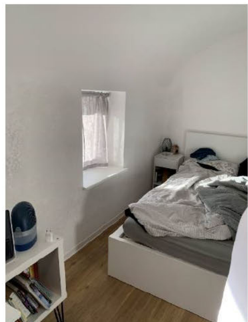
Bild 12 von 60 Blick in das Schlafzimmer und auf die Feuchtigkeitsschäden
