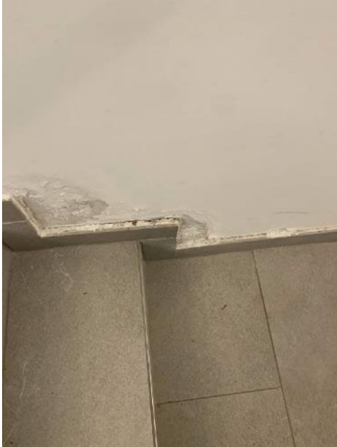
Bild 45 von 60 Blick auf Feuchtigkeitsschäden im Erdgeschoß beim Abgang zu den Kellerabteilen
