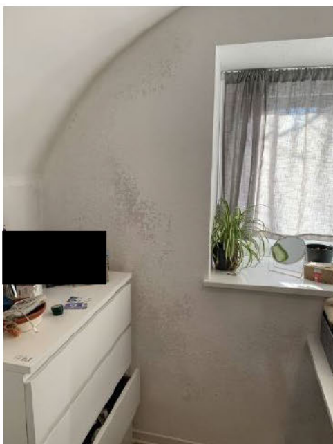
Bild 11 von 60 Blick auf die Feuchtigkeitsschäden im Schlafzimmer
