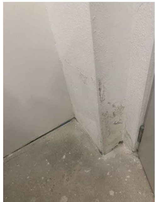
Bild 48 von 60 Blick auf Feuchtigkeitsschäden im Kellerbereich
