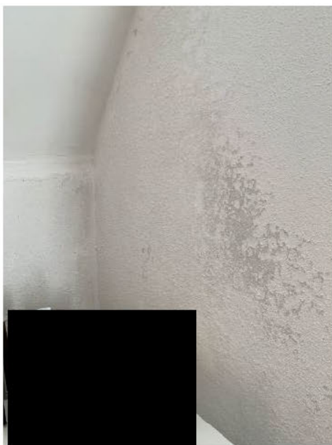
Bild 15 von 60 Blick auf die Feuchtigkeitsschäden im Schlafzimmer
