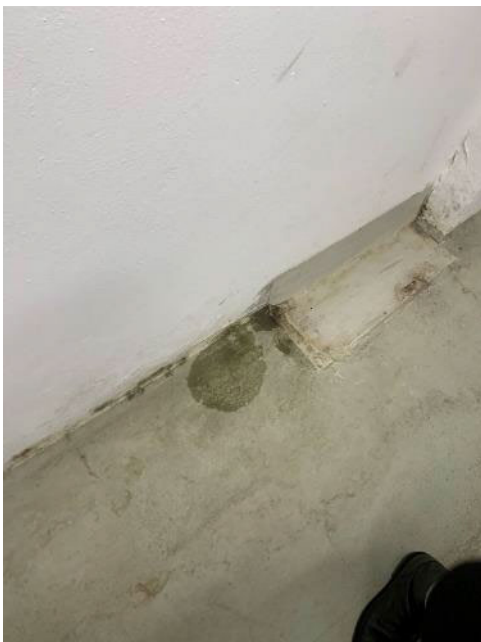
Bild 47 von 60 Blick auf Feuchtigkeitsschäden im Keller
