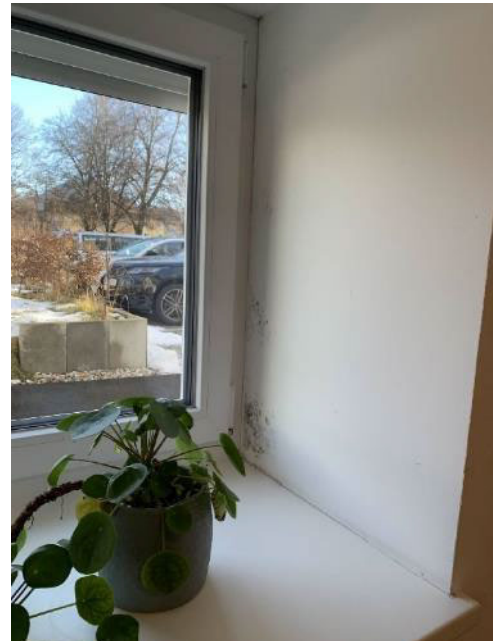
Bild 18 von 60 Blick auf ein Fenster im Wohnzimmer und hier auf die Feuchtigkeitsschäden
