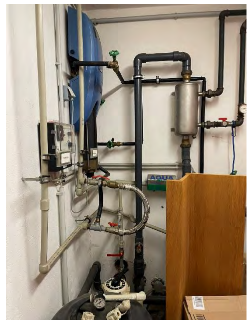
Bild 48 von 63 Blick auf die Pooltechnik im Heizraum
