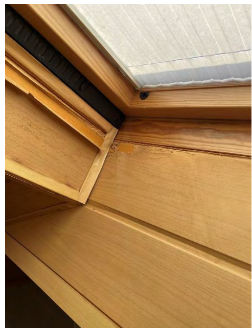
Bild 20 von 63 Blick auf die Spuren von Wassereintritten beim Dachflächenfenster
