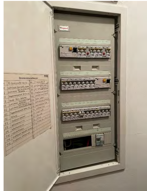
Bild 6 von 63 Blick in den Sicherungskasten
