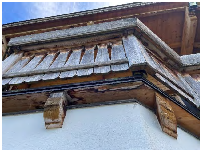
Bild 60 von 63 Blick auf Ausblühungen an der Holzuntersicht
