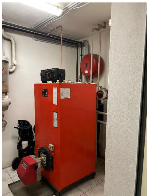
Bild 47 von 63 Blick auf den Heizkessel im Heizraum
