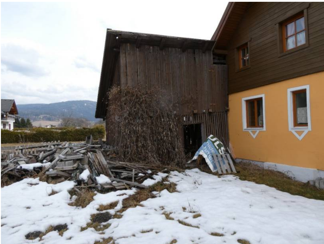
Nordwestansicht baufällige Holzlage
