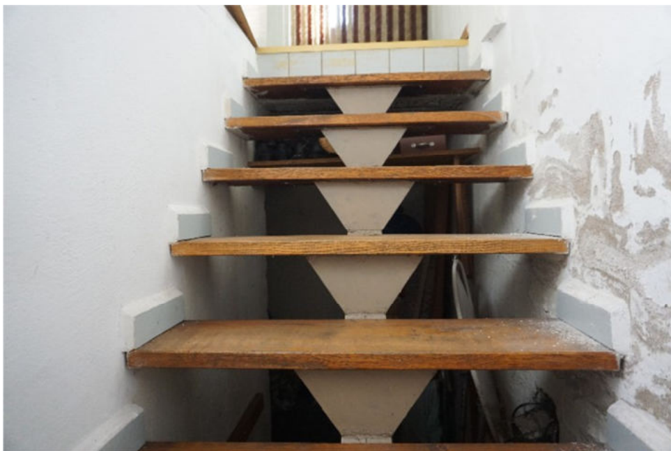
Bild 20: Kellertreppe und punktuelle Feuchtigkeitsschäden
