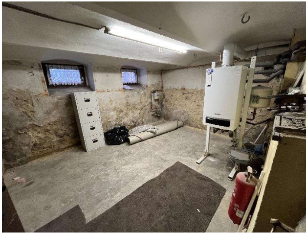
Kellerraum mit Heizungskessel
