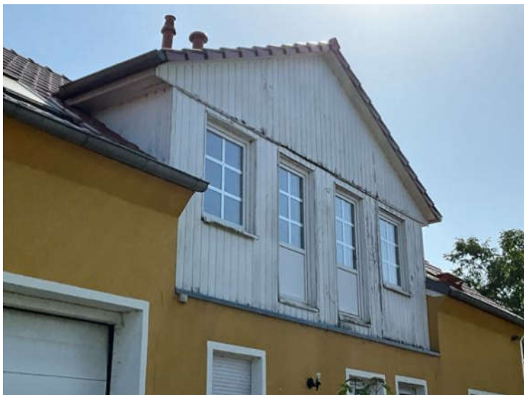
Bild 9: Feuchte- und Substanzschäden im Fassadenbereich der Holzverkleidung im Dachgeschoss
