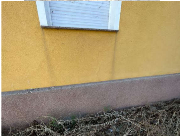
Bild 7: Feuchte- und Substanzschäden im Fassadenbereich
