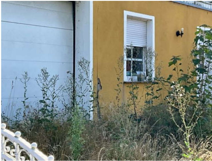
Bild 8: Feuchte- und Substanzschäden im Fassadenbereich neben der Garage
