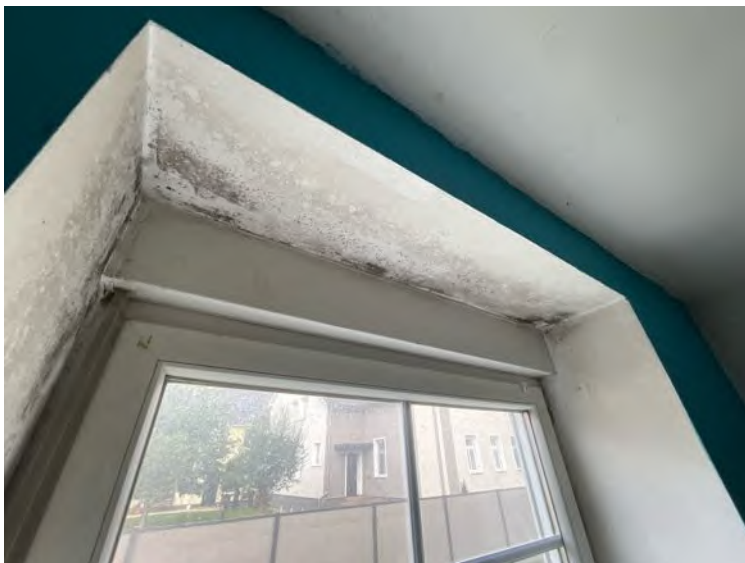
Bild 49: Feuchte und Substanzschäden im Fensterlaibungsbereich
