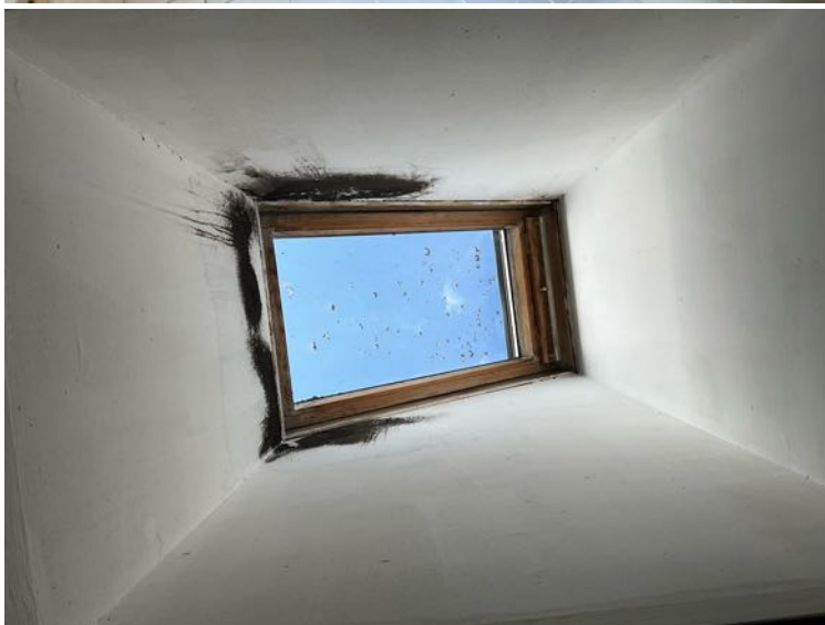
Bild 80: Oberlicht mit Feuchte- und Substanz- schäden
