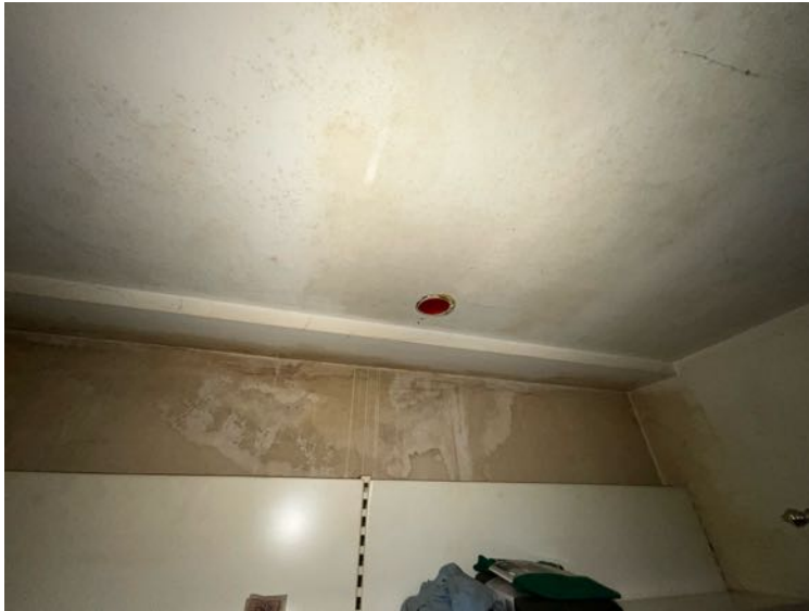
Bild 35: Feuchte- und Substanzschäden im Deckenbereich sowie Luftauslass Umluftanlage
