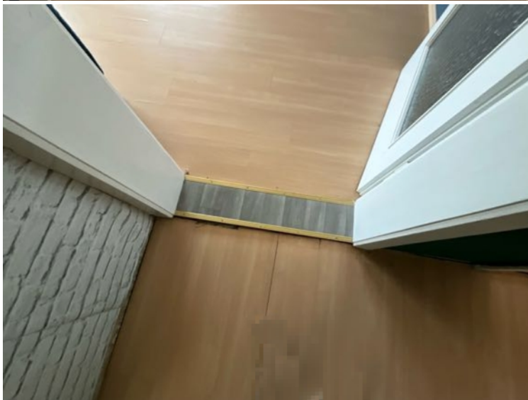
Bild 67: mangelhafter Materialübergang im Fußbodenbereich
