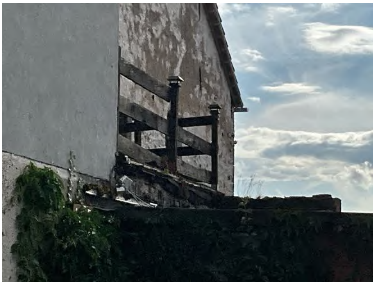
Bild 10: Feuchte und Substanzschäden im Bereich der Dachterrasse im Obergeschoss
