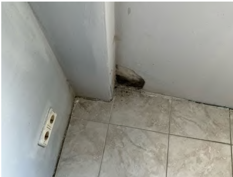
Bild 48: Feuchte und Substanzschäden im Wandbereich sowie Beschädigungen im Übergangsbereich Fußboden/Wand
