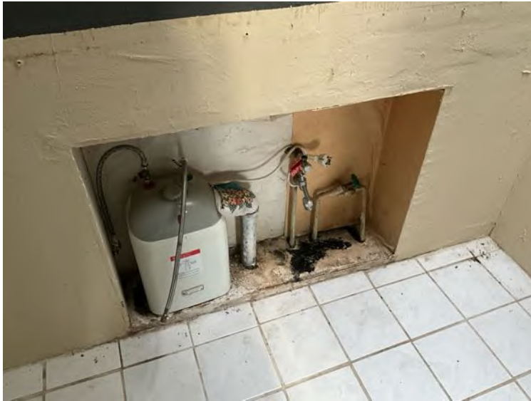
Bild 88: Durchlauferhitzer in der Küche (OG links)
