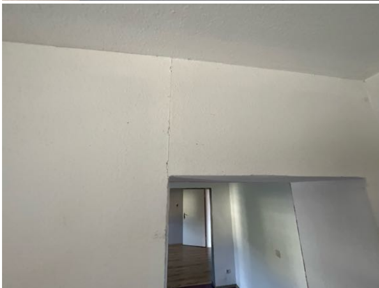
Bild 101: Rissbildungen im Wandbereich
