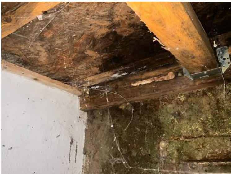
Bild 16: Feuchte- und Substanzschäden im Dachbereich des Anbaus
