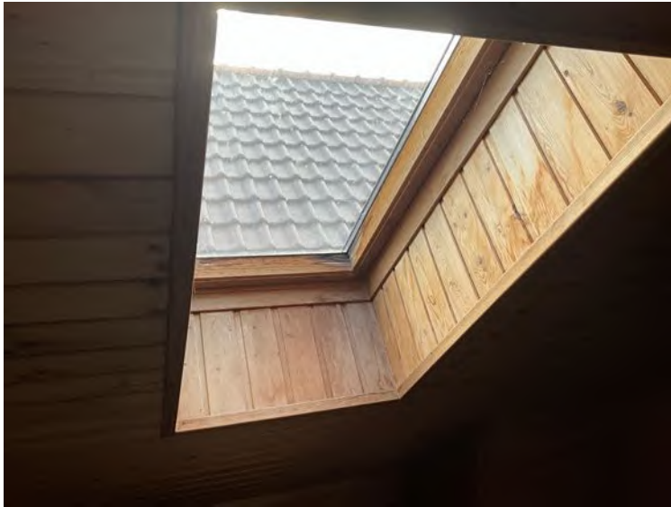
Bild 117: Feuchte- und Substanzschäden im Bereich des Dachflächenfensters
