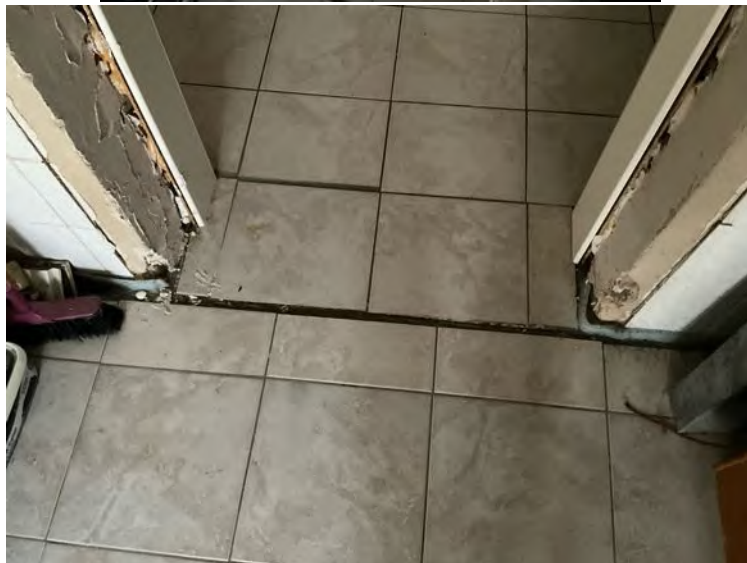
Bild 32: Substanzschäden im Bereich der Türleibung und des Fußbodens
