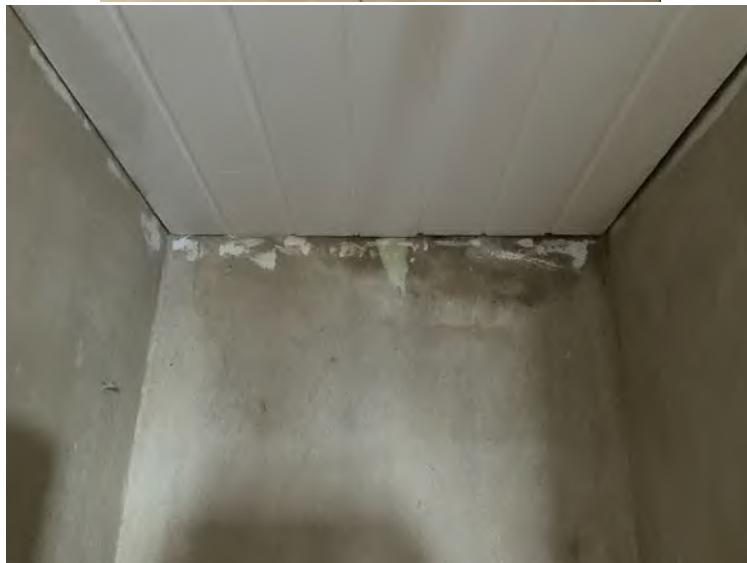
Bild 63: Feuchte- und Substanzschäden im Wandbereich
