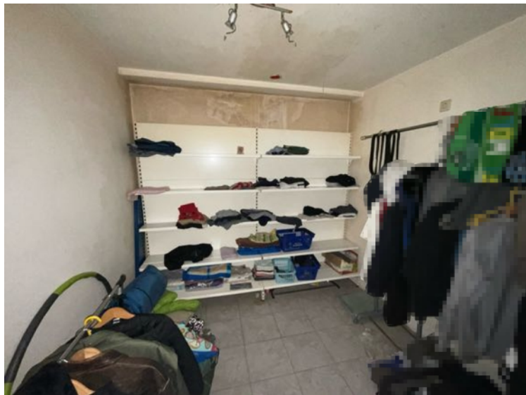
Bild 34: weiterer Raum (EG) ohne natürliche Belichtungs- und Belüftungsmöglichkeiten und mit Feuchteschäden im Wandbereich
