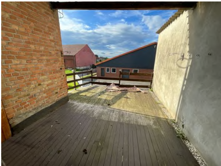
Bild 92: Terrasse (OG rechts) mit umfangreichen Feuchte- und Substanzschäden im Fußboden- und Geländerbereich
