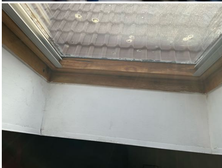
Bild 143: Feuchte- und Substanzschäden im Be- reich des Dachflächenfen- sters
