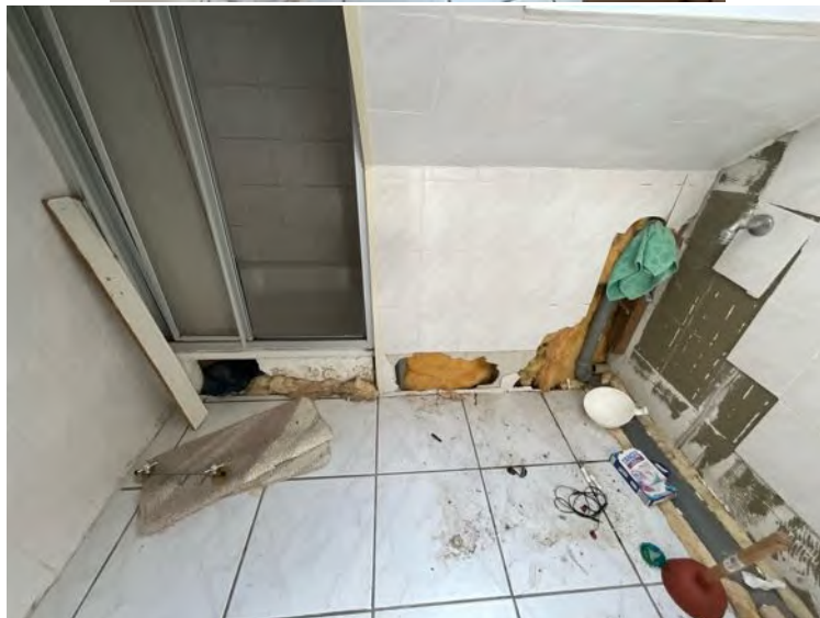
Bild 126: Substanzschäden im Wand- und Fußbodenbereich
