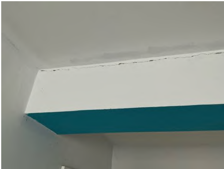
Bild 50: Rissbildungen im deckenbereich
