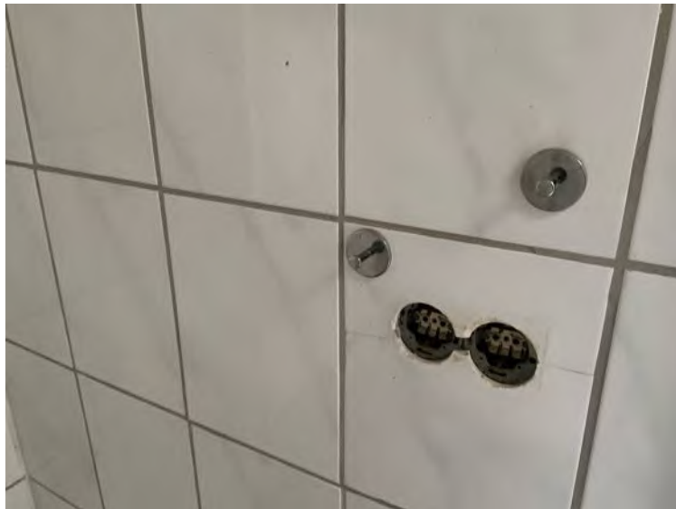
Bild 85: beispielhafte Beschädigung bzw. Mangel der Elektroausstattung
