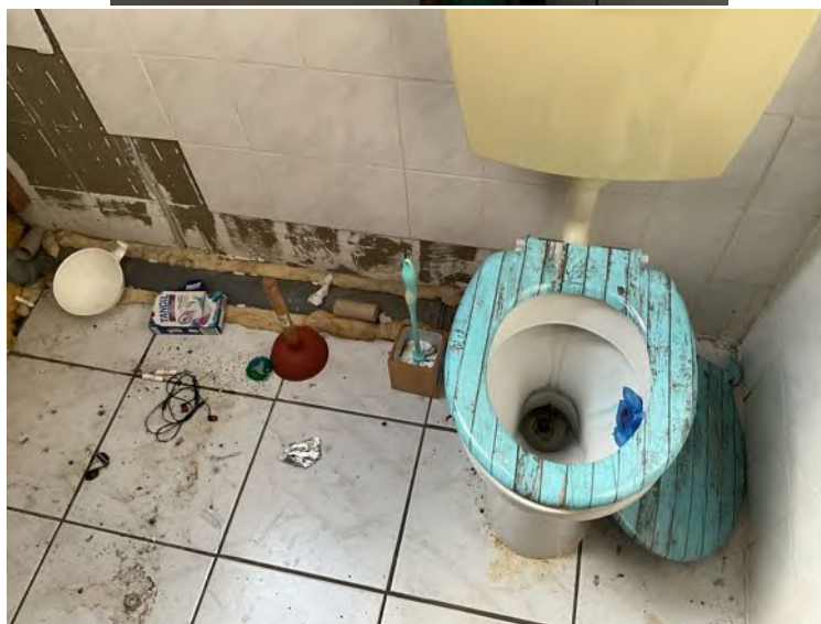
Bild 128: Substanzschäden im Wand- und Fußbodenbereich sowie der Sanitär-einrichtung
