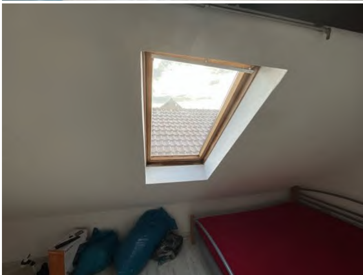
Bild 124: Feuchte- und Substanzschäden im Bereich des Dachflächenfensters
