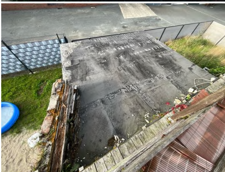
Bild 11: Feuchte und Substanzschäden im Bereich des Dachs des Anbaus
