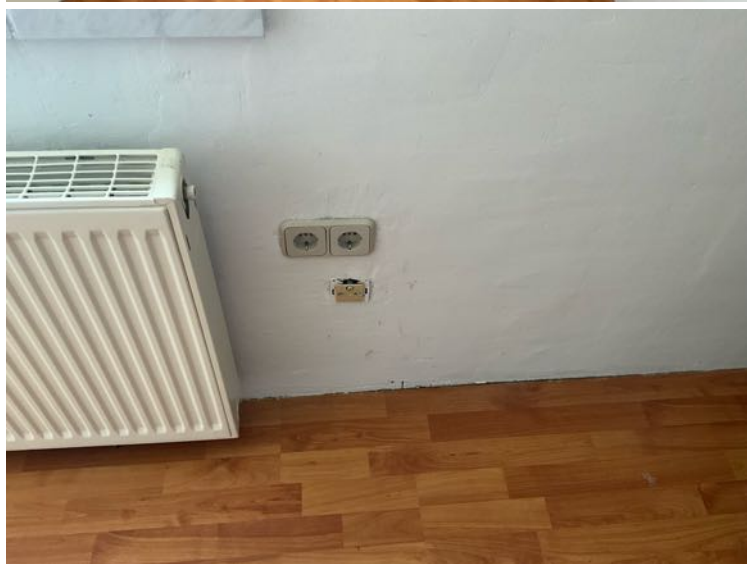
Bild 70: beispielhafte Beschädigung bzw. Mangel der Elektroausstattung
