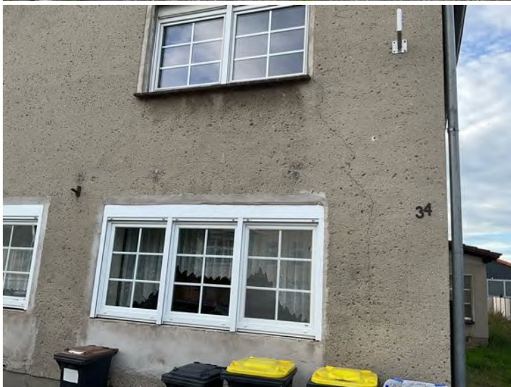
Bild 4: beispielhafte Sub- stanzschäden im Fassa- denbereich
