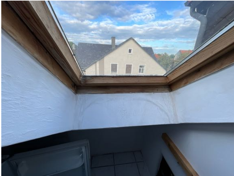
Bild 120: Feuchte- und Substanzschäden im Bereich des Dachflächenfensters
