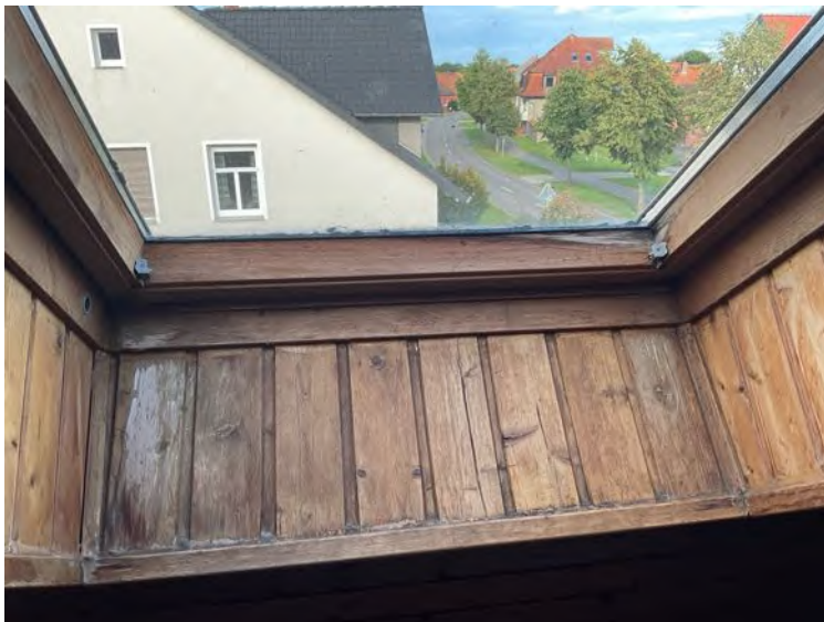
Bild 115: Feuchte- und Substanzschäden im Bereich des Dachflächenfensters
