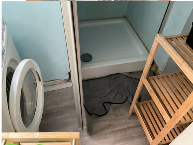
Bild 132: Substanzschäden im Wandbereich
