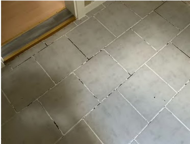
Bild 81: Fußbodenbelag mit Substanzschäden
