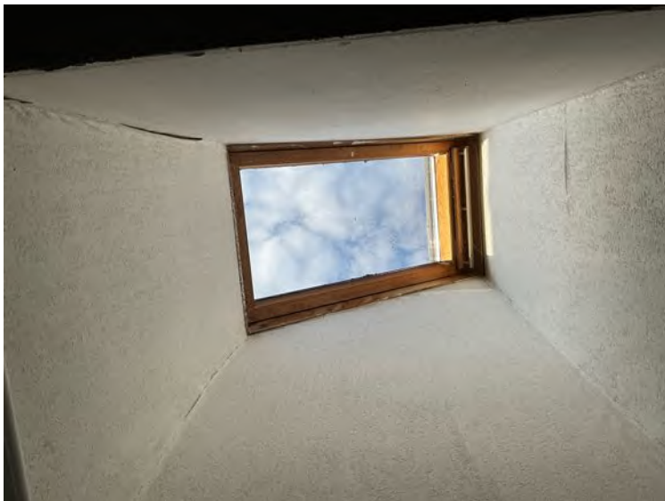
Bild 89: Oberlicht mit Feuchte- und Substanzschäden
