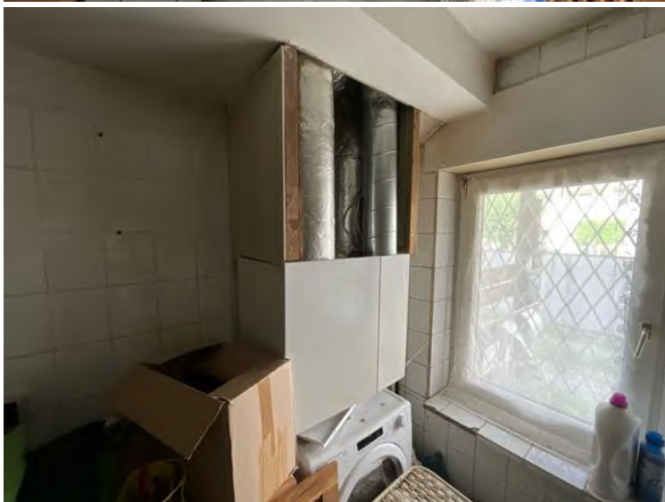
Bild 30: Küche (EG) mit Teilen der Umluftanlage
