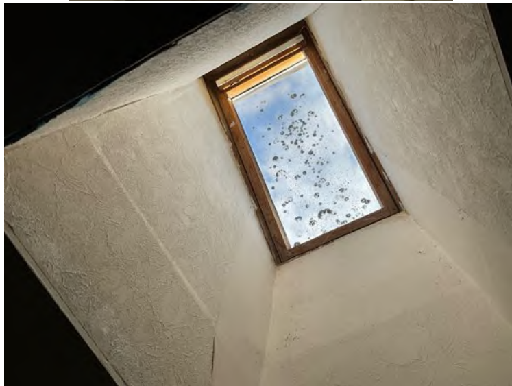
Bild 84: Oberlicht mit Feuchte- und Substanz- schäden
