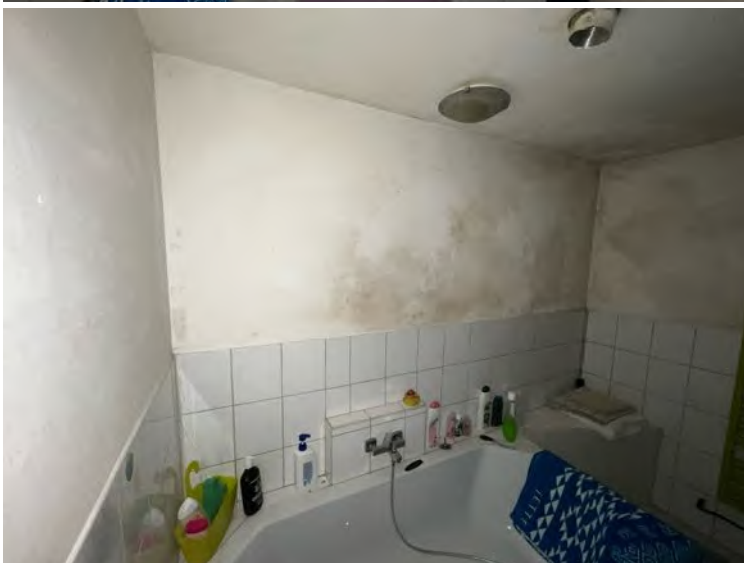
Bild 44: Bad/WC (EG) mit Feuchte- und Substanzschäden im Wandbereich
