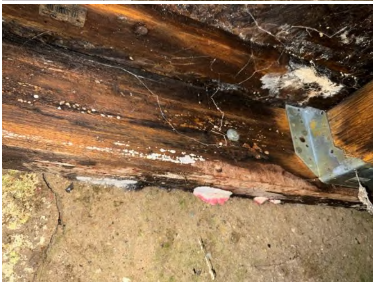
Bild 17: Feuchte- und Substanzschäden im Dachbereich des Anbaus
