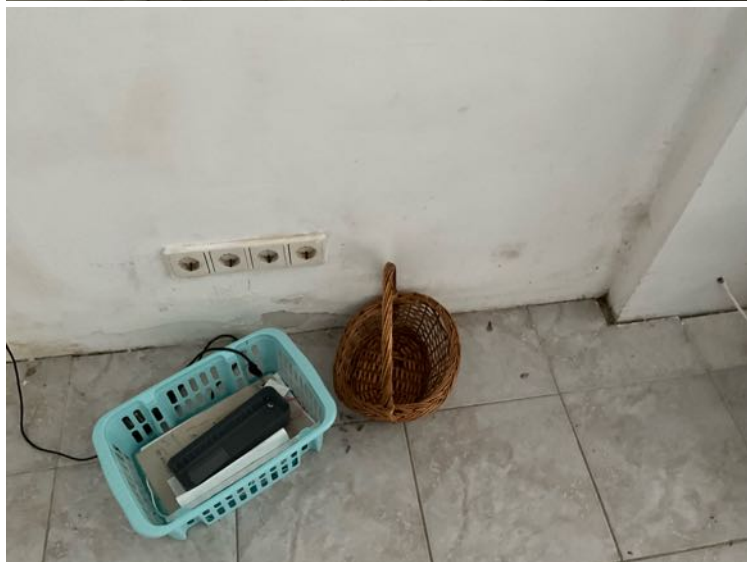
Bild 39: Feuchte und Substanzschäden im Wandbereich sowie Beschädigungen im Übergangsbereich Fußboden/Wand
