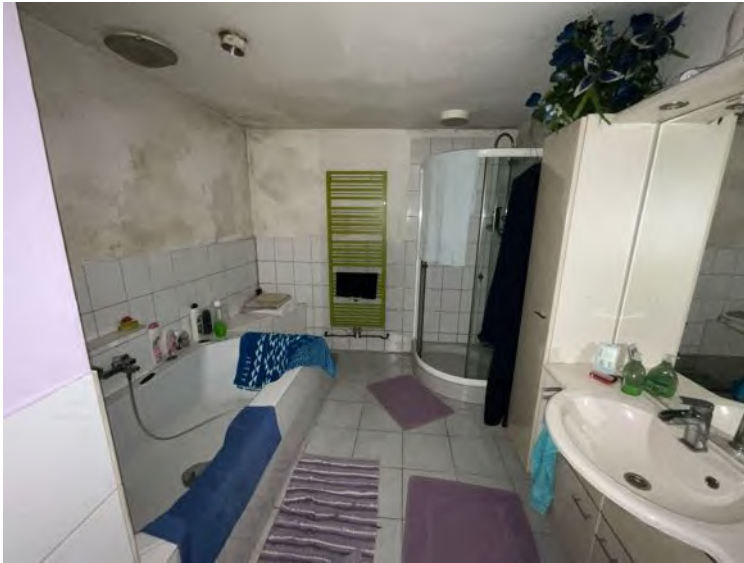
Bild 42: Bad/WC (EG) ohne natürliche Belichtungs- und Belüftungsmöglichkeiten mit Feuchte- und Substanzschäden im Wandbereich
