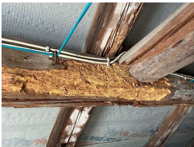
Detailansicht Dachbalken mit Schädlingsbefall
