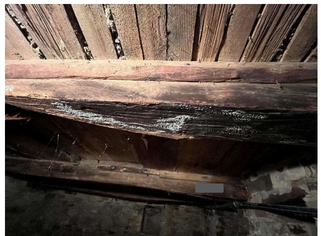
Detailansicht Kellerdecke mit Pilzbefall
