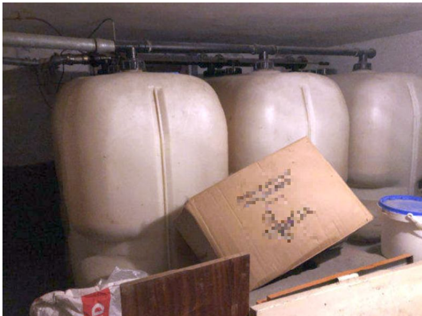
Bild 30: Öltanks (außer Betrieb)
