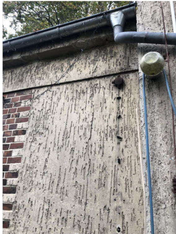
Bild 31: punktuelle Risse an der Hausfassade, beispielhaft
