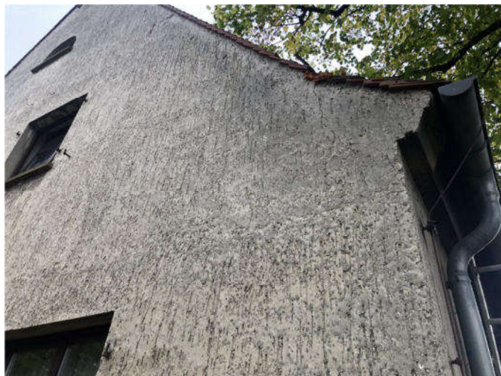
Bild 30: punktuelle Risse an der Hausfassade, beispielhaft
